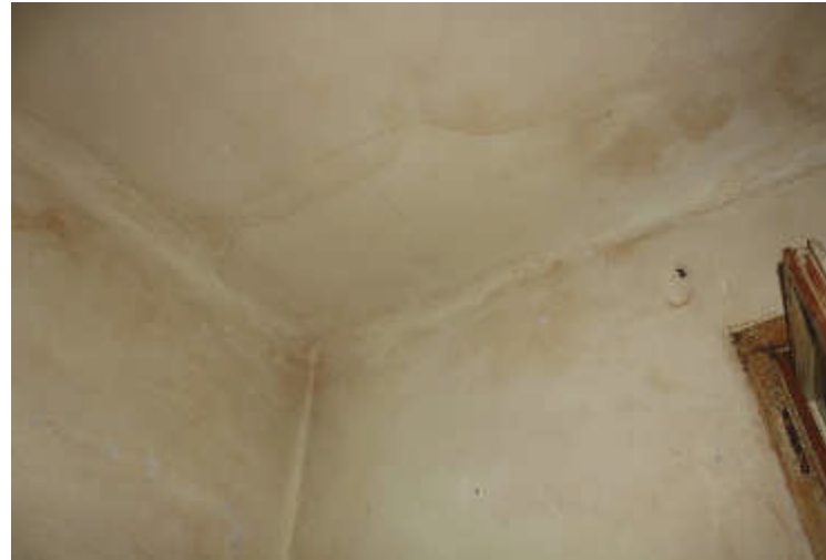
Abb. 135 | verschmutzte Wand- und Deckenoberfläche
