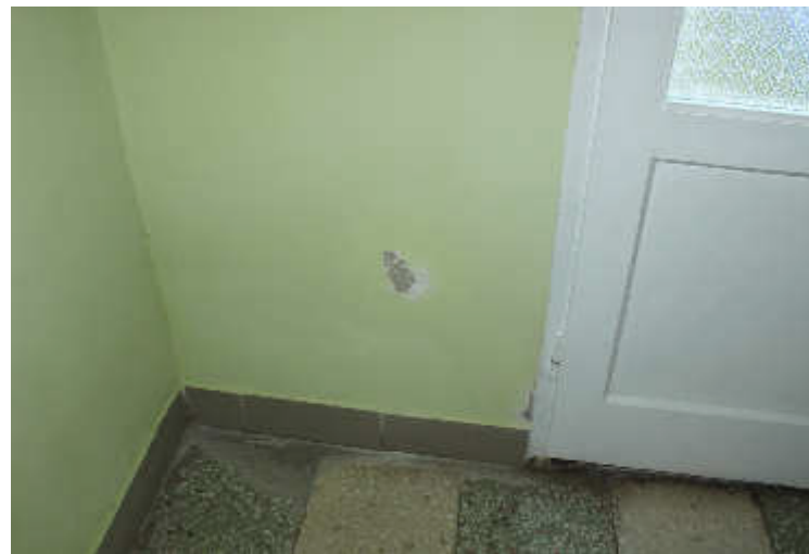
Abb. 136 | Abplatzung des Schichtpaketes in der Sockelzone
