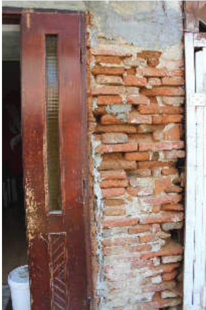
Abb. 151 (rechts) | Materialverlust am Querflügel, spätere zementhaltige Ausbesserungen an der Fassade
