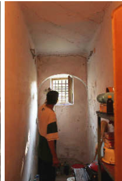
Abb. 152 (links) | Wasserflecken im Raum C101
