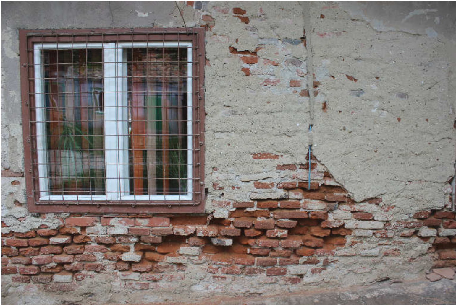
Abb. 156 | Stark deformierte Wandoberfläche im Außenbereich des Raumes A109
