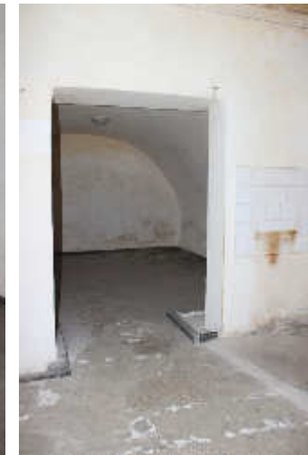
Abb. 120 (links) | Feuchtigkeits- schäden
