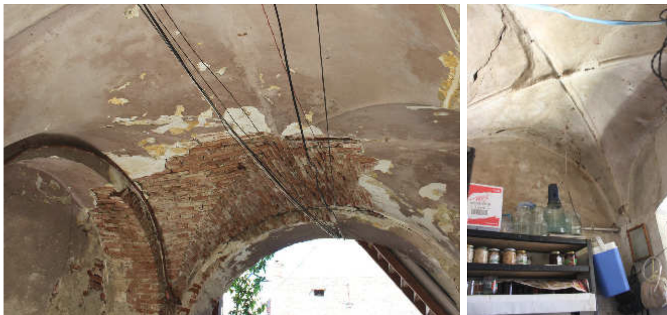
Abb. 148 (links) | Abplatzungen, Verlust bis auf das Mauerwerk im Durchgang des Querflügels von Körper A
