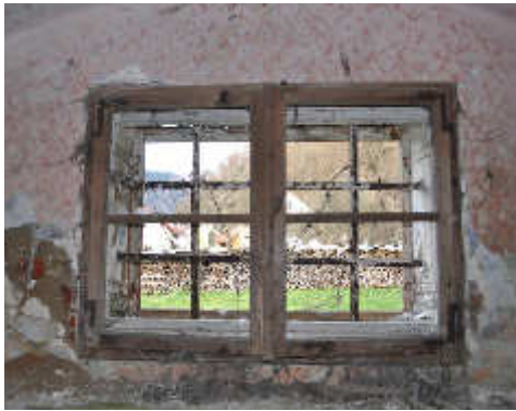
Abb.70. Ansicht Fenster mit vorgesetztem Rahmenstock
