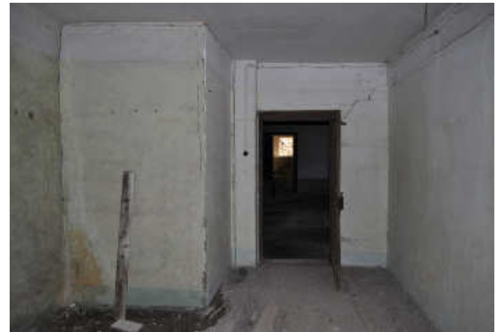
Abb.111. Eingang Raum 11, Wand c.a
