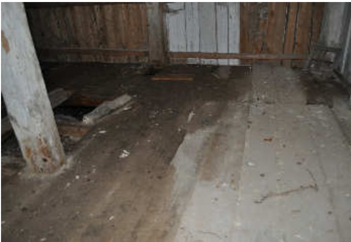
Abb.91. Übergang feuchte zu trockene Bodenbretter
