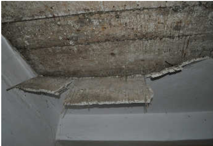
Abb.80. Decke mit abgelöstem Putzaufbau
