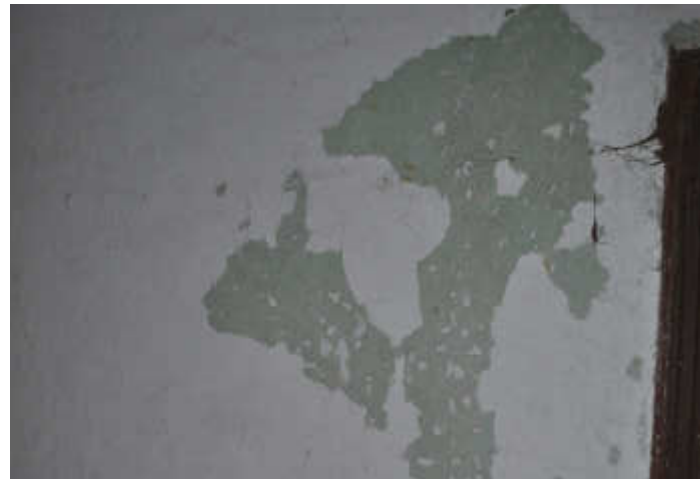
Abb.81. Großflächiger Verlust des Anstrichs, Wand a
