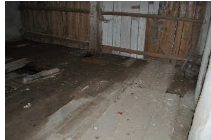
Abb.140. Feuchter Boden im EG
