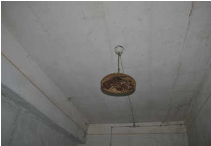
Abb.98. Lampe mit Leitungen die auf Putz verlegt sind
