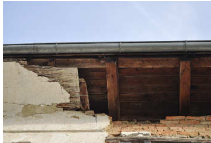
Abb.142. Abgelöste Schalungsbretter der Dachtraufe
