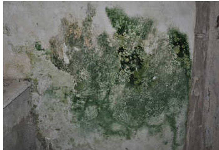
Abb.116. Schimmel im Bereich des Mauerbogens, Wand c
