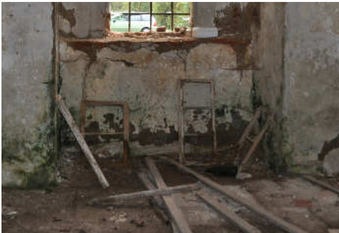
Abb.143. Sockelzone mit Schimmel
