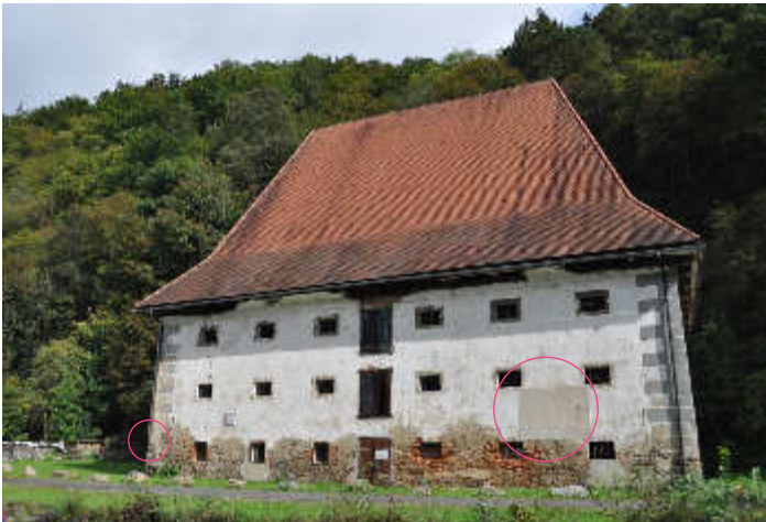
Abb.141. Westfassade: links: fehlende Dachrinne; rechtes: Quadrat aus Zementputz
