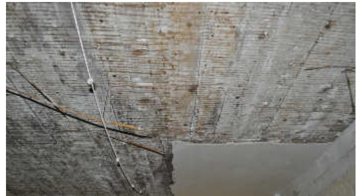
Abb.144. Abgelöster Putzaufbau der Decke im EG
