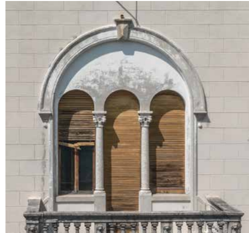
LINKS: Abb. 88 Pulverisierung der Putze an der Lünette des zentralen Drillingsfensters. Polverizzazione degli intonaci sulla lunetta centrale. RECHTS: Abb. 89 Abblättern des Putzes an einigen Stellen der Fassade. Esfoliazione dell'intonaco in alcuni punti della facciata.
