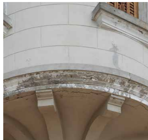
LINKS: Abb. 90 Rissbildung am Gurtgesims aus Beton des Erkers, aufgrund einer beginnenden Karbonatisierung. Fessurazione sul marcapiano in calcestruzzo dell'Erker, a causa di un principio di carbonatazione. RECHTS: Abb. 91 Verwitterung der Betonüberdeckung an der Unterseite der Balkons. Disgregazione del copriferro nei sottobalconi.
