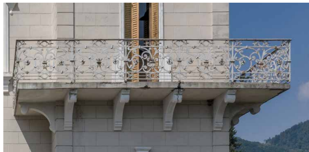
Abb. 92 Riss an der zweiten Stützkonsolle des Balkons. Profonda fessurazione della seconda mensola di sostegno del balcone.
