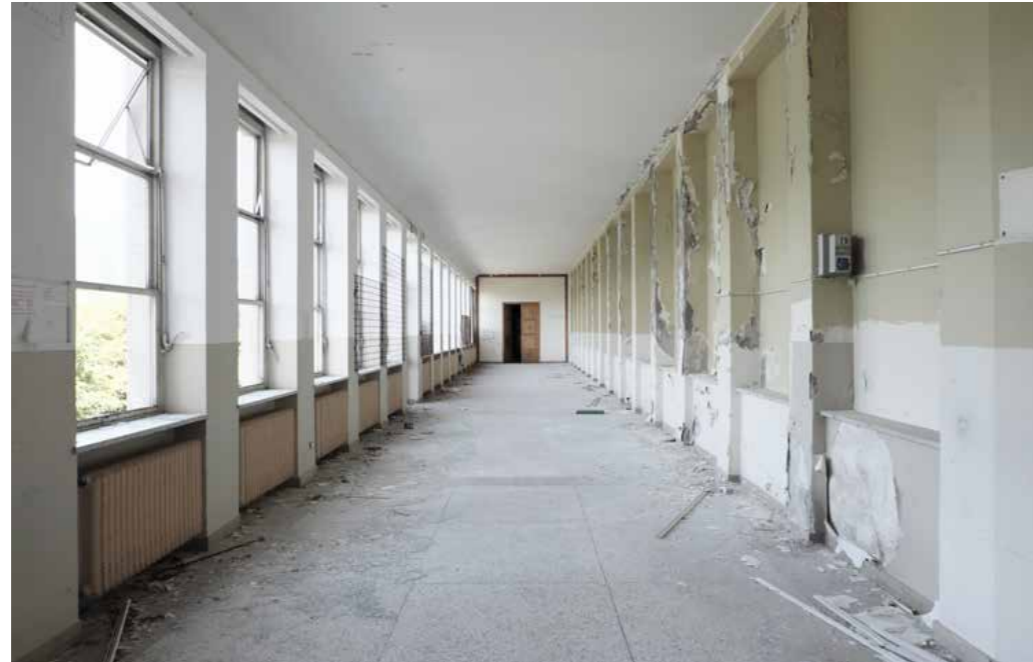
Abb. 174 Raum Nr. 1.08, Durchgang zur Kirche. Stanza nr. 1.08, corridoio di collegamento con la chiesa.
