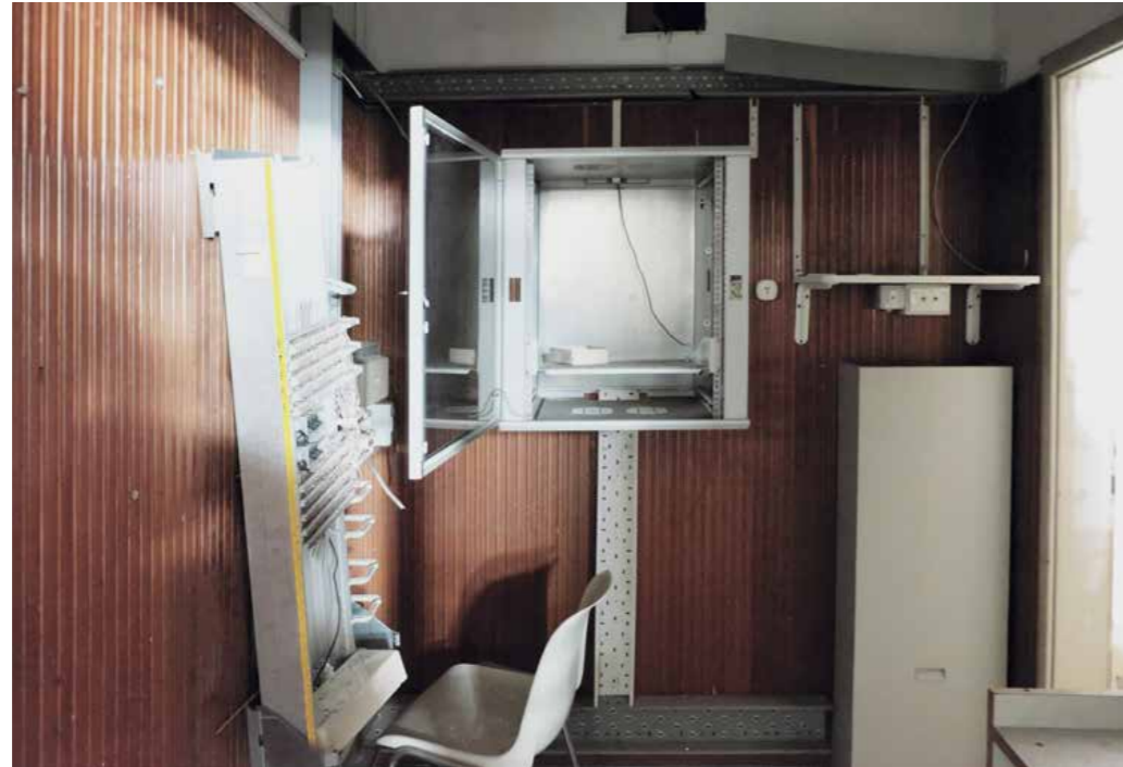
Abb. 141 Raum Nr. 04, Technischer Raum, elektrische und Netzwerkschränke. Stanza nr. 04, locale tecnico, quadri tecnici e di rete.
