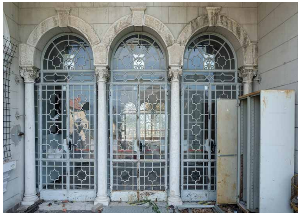
Abb. 104 Jugendstil-Verglasung. Viele Rostzonen sichtbar. Vetrate in stile Liberty. Molte zone arrugginite.
