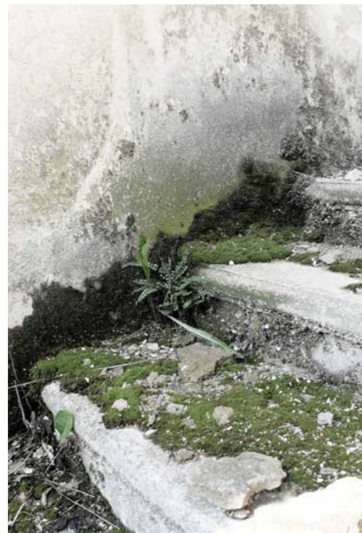
LINKS: Abb. 95 Biologischer Befall auf den Treppe und an dem Mauersockel. Palma biologica sulle scale e sulla base del muro. RECHTS: Abb. 96 Gebrochene Brüstung der Treppe. Rottura del parapetto delle scale.
