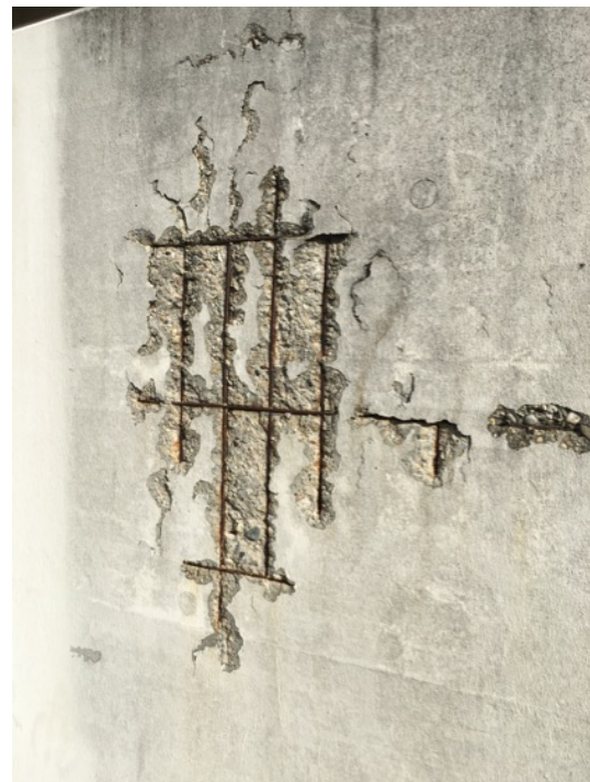
Abb. 67 Offengelegte Armierung Wiener Flur
