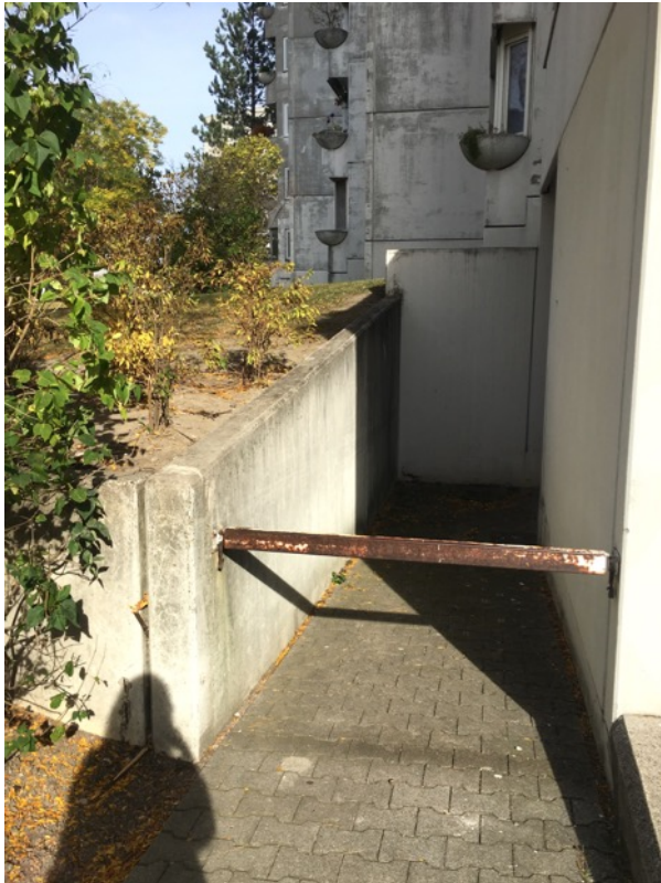
Abb. 70 Metall Korrosion Wiener Flur
