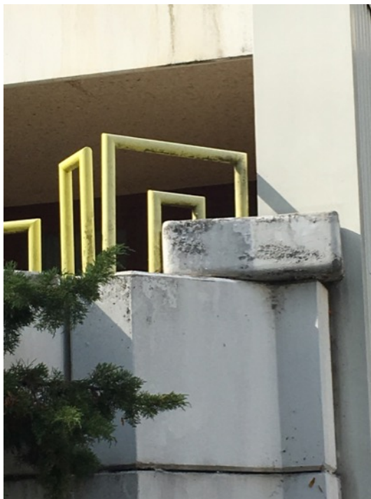
Abb. 66 Beton Blättern Heinz-Nittel-Siedlung
