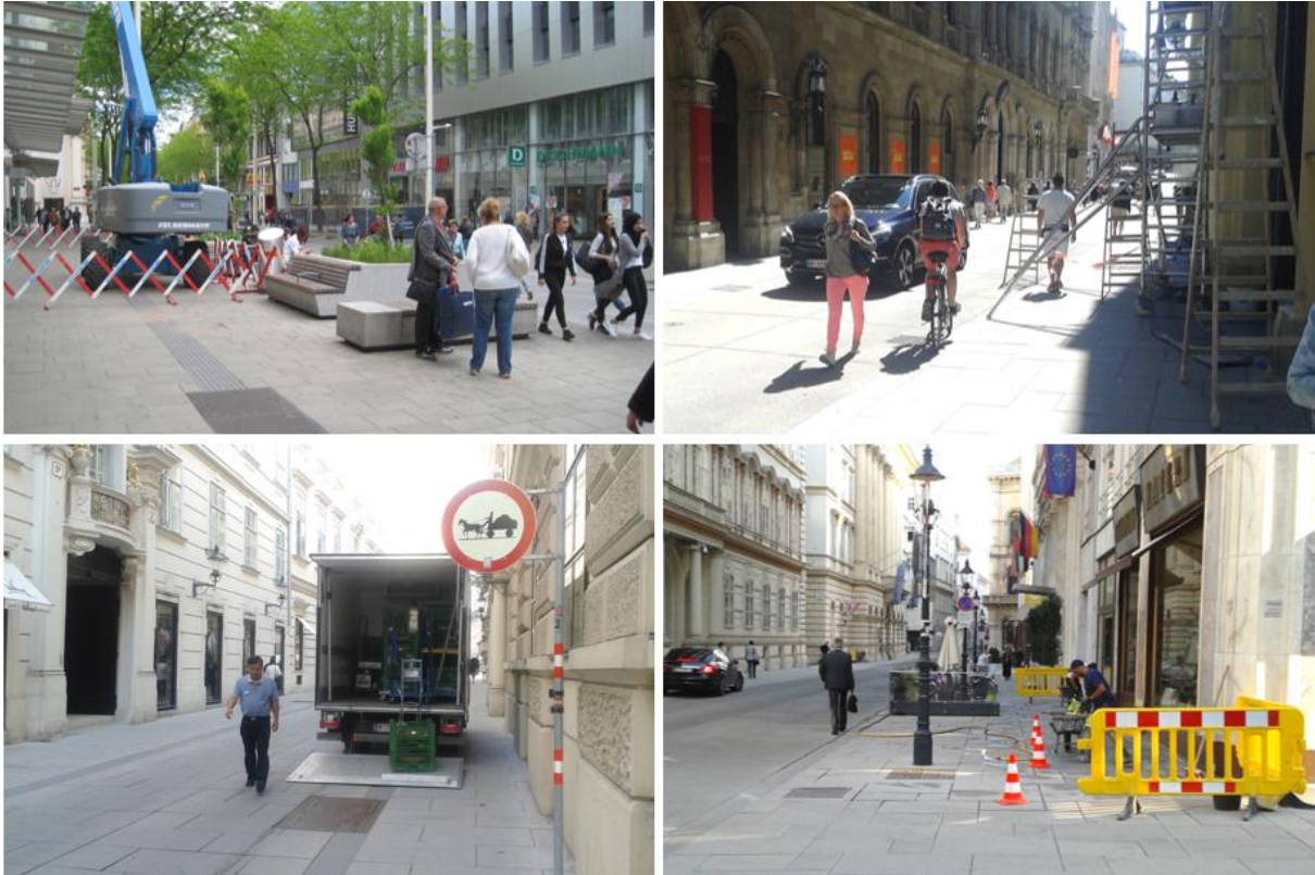
Abbildung 66: temporäre Verengung des Straßenquerschnitts durch Baumaßnahmen bzw. regelwidriges Halten von Kfz
