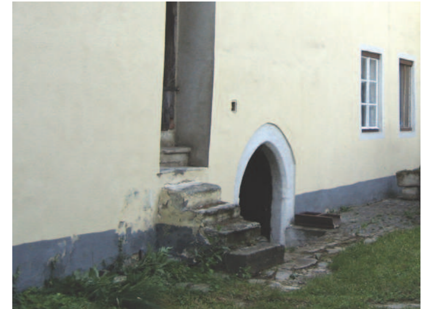
Abb. 5.37 Ansicht der Hoffassade, Putzschäden im Bereich der ehemaligen Öffnung links neben der Treppenanlage
