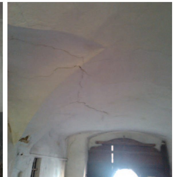
Abb. 5.10 Riss im Tonnengewölbe des nördlichen Abschnittes
