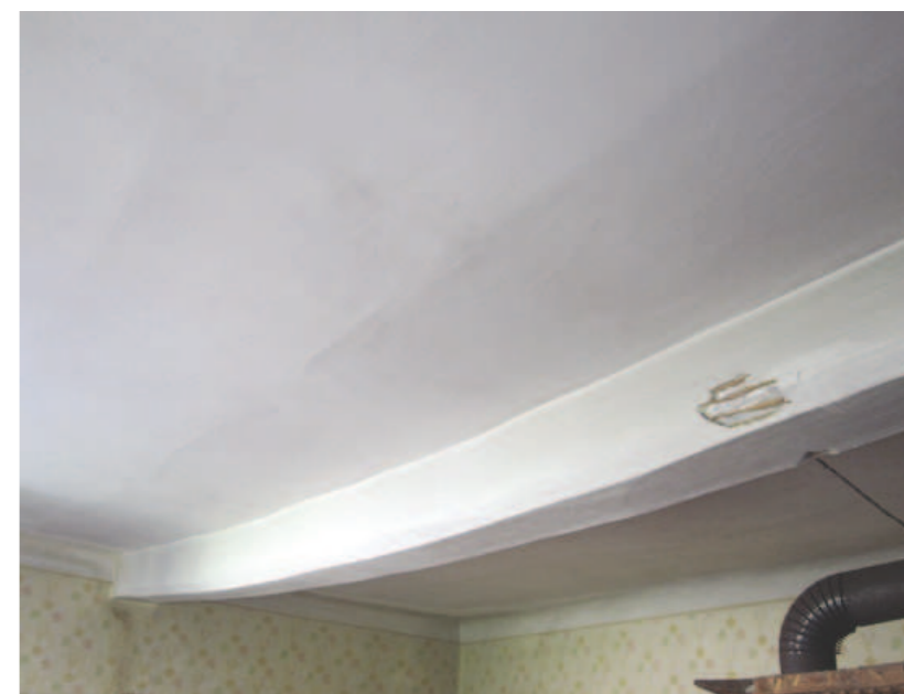
Abb. 5.30 Sichtbare Verformung des Unterzuges
