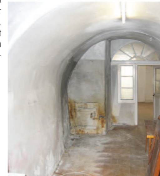
Abb. 5.20 Raum A.0.03 Blickrichtung Norden Farbveränderungen im Bereich der Öffnung des nördlichen Kaminzuges
