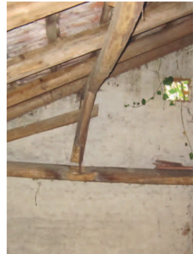
Abb. 5.111 Schadhafter Anschluss der Stuhlsäule an den Trägerbalken an der Südwand
