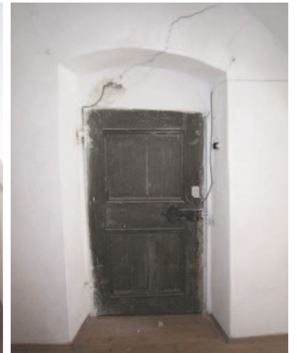
Abb. 5.64 Rissbildung in der Westmauer über der Tür zu Raum A.1.02
