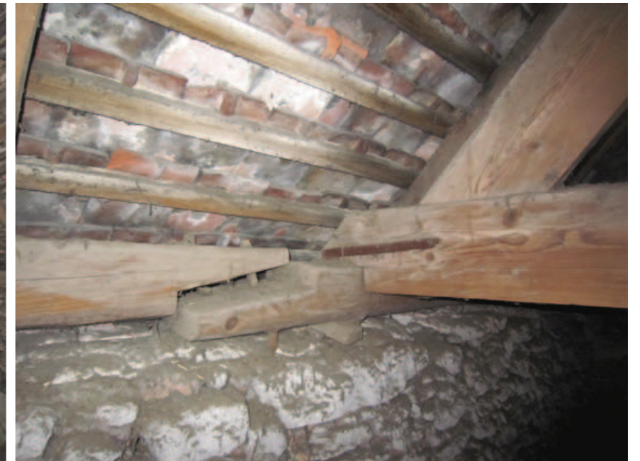
Abb. 5.100 Verformung der Fußpfette, Westmauer
