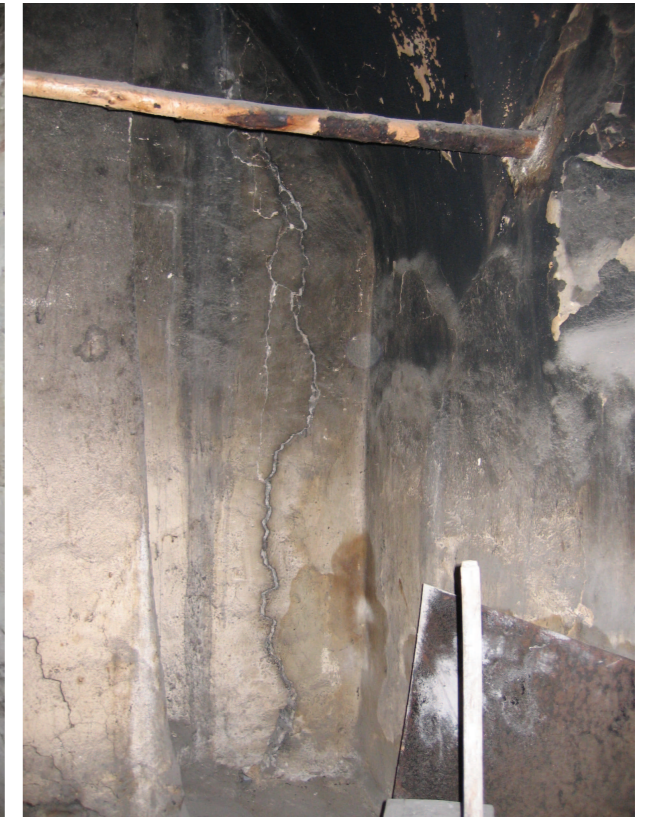
Abb. 5.70 Vertikaler Riss in der Südmauer
