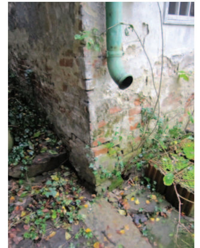
Abb. 5.108 Riss im Mauerwerk in der süd-östlichen Ecke
