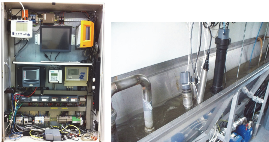
Abbildung 16: Schaltschrankaufbau (links) und Messwanne (rechts) (Foto: Autor)
