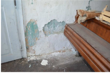
Abb. A.0.04.5 Zimmer, Detailaufnahme Salzausblühungen an Innenwand zu Raum A.0.03 Lager (Eigenaufnahme vom 27.08.2016)
