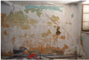
Abb. A.0.04.6 Zimmer, beschädigtes Mauerwerk an der Außenwand zum Nachbargrundstück (Eigenaufnahme vom 27.08.2016)
