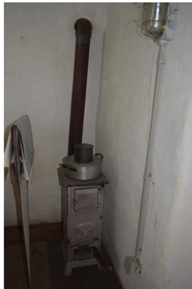
Abb. A.1.13.2 Gang, Detailaufnahme Ofen (Eigenaufnahme vom 27.08.2016)
