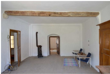
Abb. A.1.03.1 Zimmer, Blick Richtung Kapelle, hölzerner Unterzugbalken (Eigenaufnahme vom 27.08.2016)
