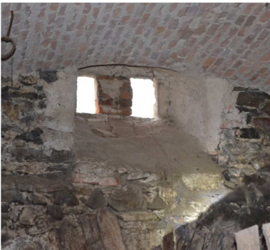
Abb. A.-1.04.2 Keller, Detailaufnahme Belichtungs- und Belüftungsluken zur straßenseitigen Fassade (Eigenaufnahme vom 08.12.2015)
