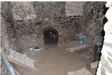
Abb. A.-1.02.2 Kellerhalle, Verteilerraum zu weiteren Kellerräumen auf unterschiedlichen Niveaus (Eigenaufnahme vom 27.08.2016)
