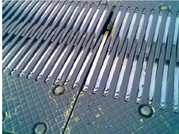
Abbildung 3.24: mechanische Beschädigung durch einen Schneepflug [31]
