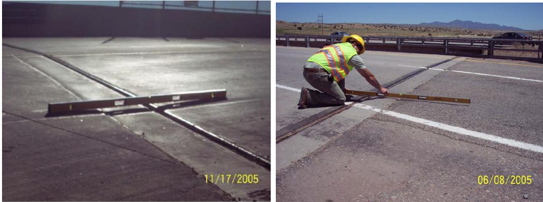
Abbildung 3.27: Setzungen und Hebungen hinter der Widerlagerwand [30]
