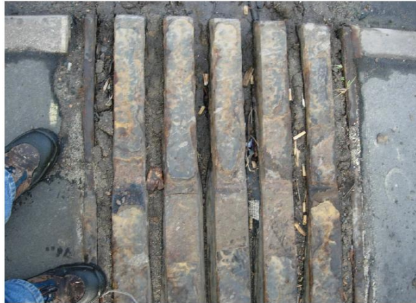
Abbildung 3.22: mangelnde Wartung eines Fahrbahnüberganges [9]
