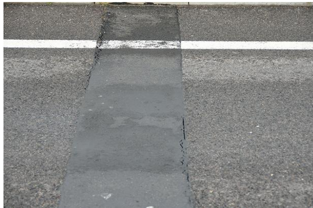
Abbildung 3.23: Rissbildung bei elastischen Belagsdehnfugen
