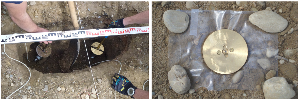
Abbildung 3.21: Setzungsmessgerät während des Einbaus und in Endlage
