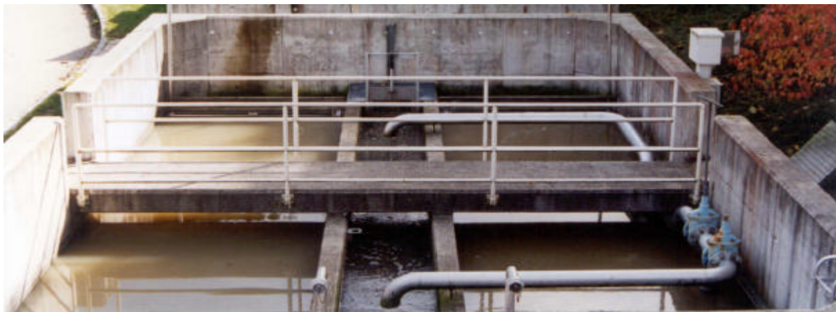
Abbildung 10: Blick auf die Oberfläche eines typischen Emscherbrunnens - in der Mitte der Gasraum mit Schwimmschlamm und seitlich die beiden Absetzräume
