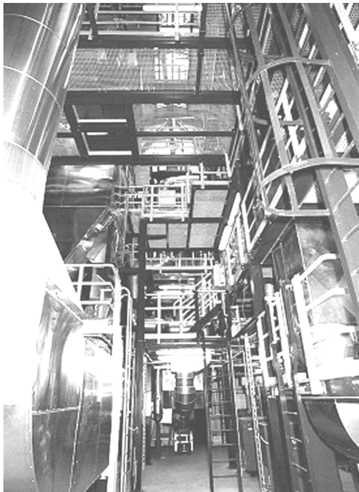
Abbildung 6: Innenansicht der Klärschlammbehandlungsanlage
