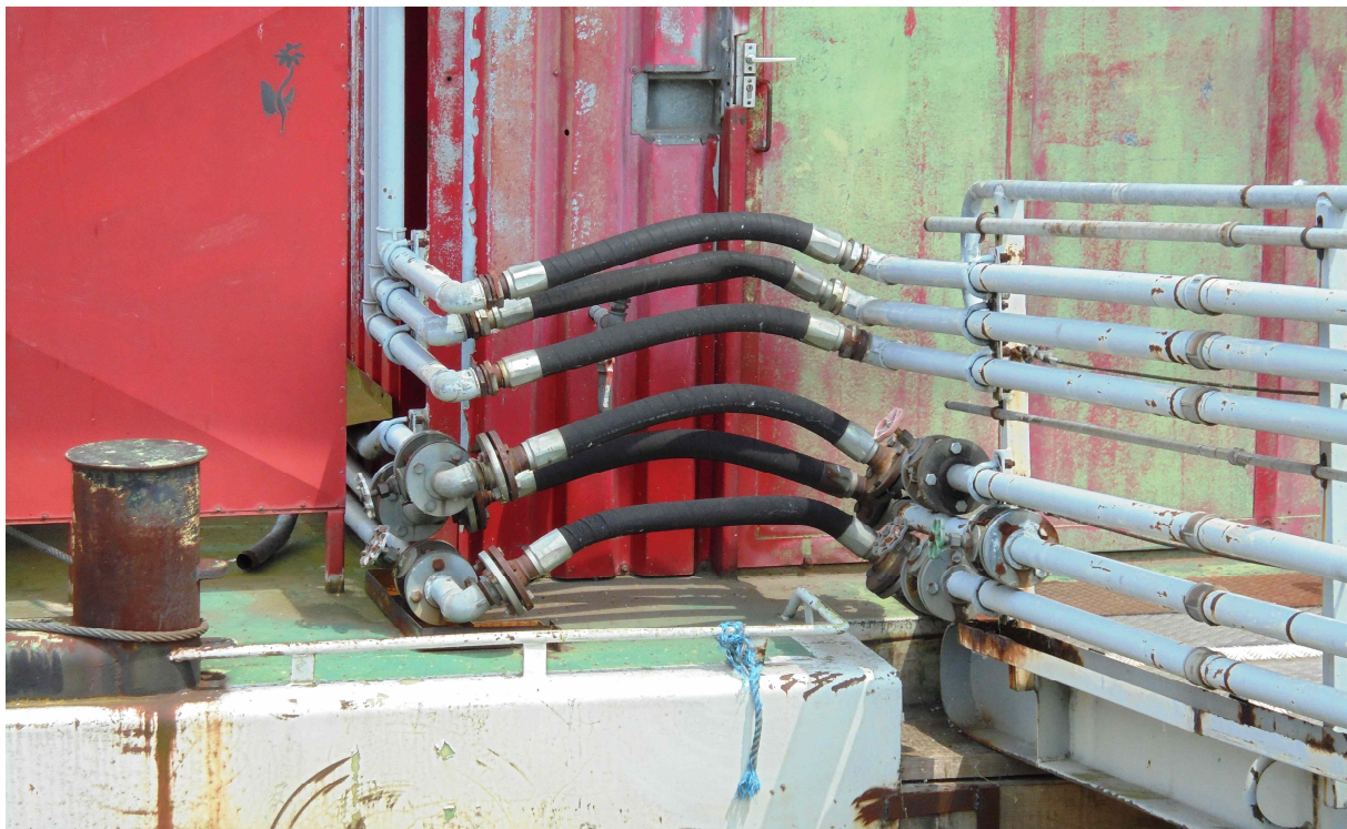
Abbildung 6.8: Detailaufnahme zu Abbildung 6.7: Flexible Schlauchleitung zur Verbindung der Rohrleitung der schwimmenden Anlage und des Steges 264
