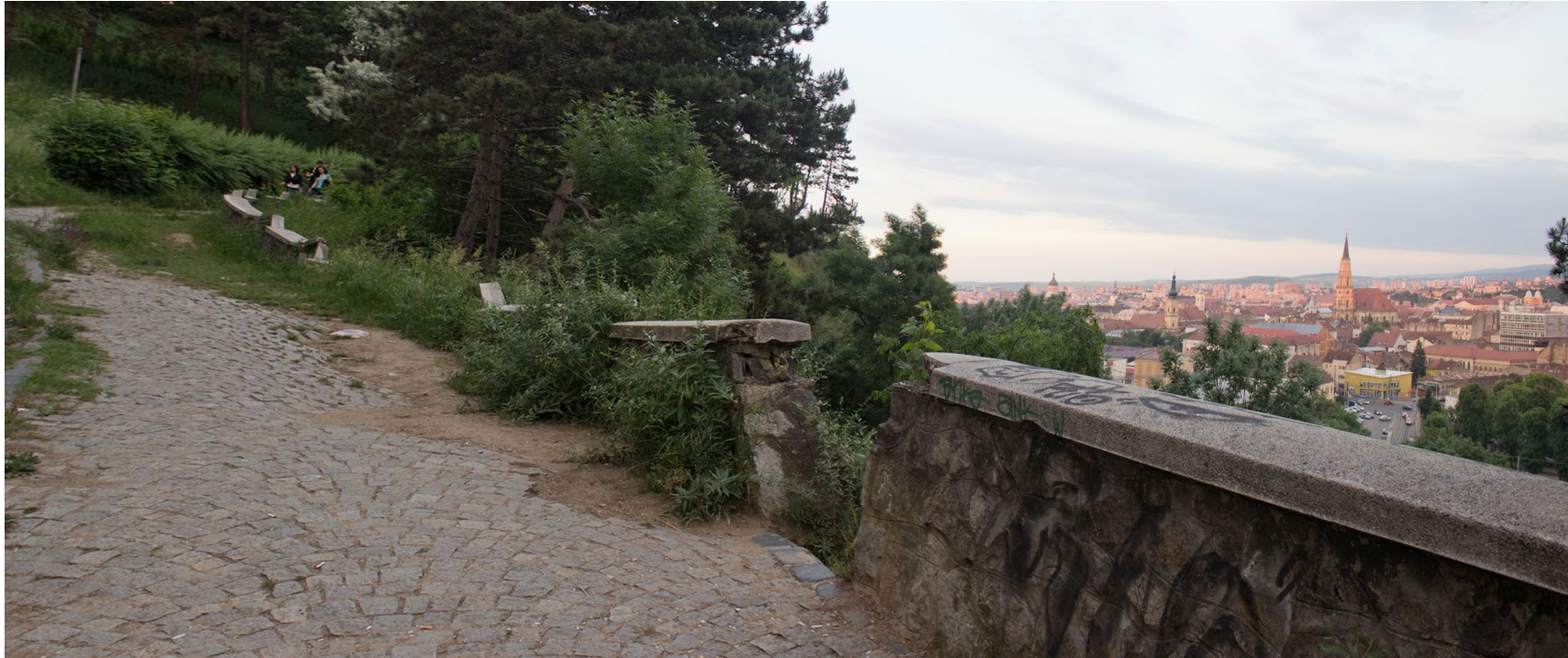
Abb. 26 | Der Pfad in seinem aktuellen Zustand. Die teilweise eingebrochenen Brüstungen sind mit einer Absturzgefahr von einigen Metern zu sehen.
