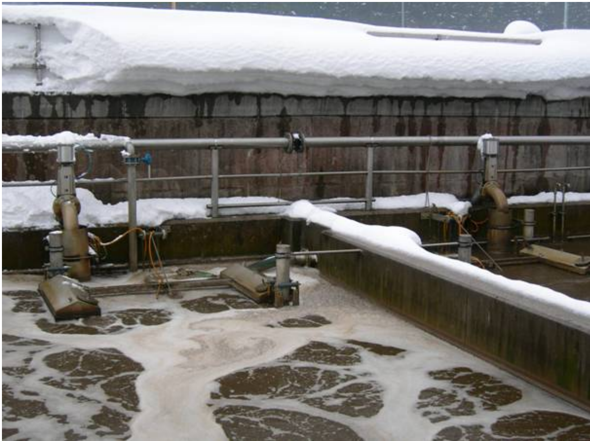
SBR-Becken mit Pontons
