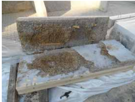
Abbildung 2.87.: SV2: Bruchfläche mit den nicht ausgezogenen Schrauben
