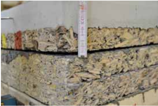
Abbildung 2.51.: Schädigung der obersten Klebefuge beim Auflager B
