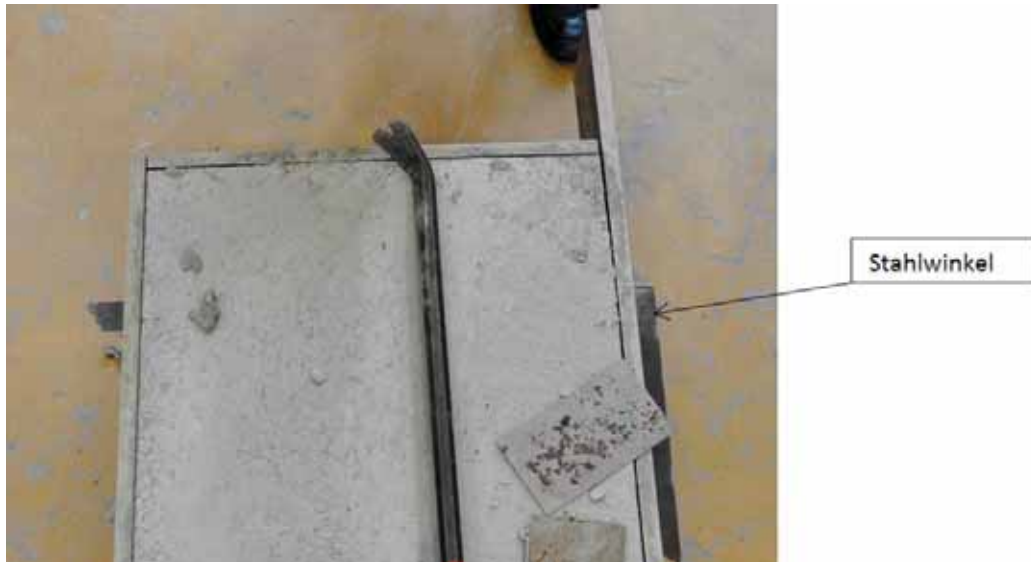
Abbildung 2.70.: Stahlwinkel durchdringt die unterste Klebefuge, bis zu 20 cm vom Bauteilende
