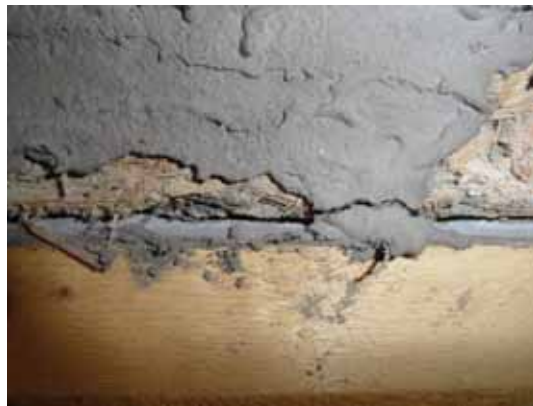
Abbildung 2.71.: Spalt in der untersten Klebefuge im Randbereich des Bauteils (allseitig)
