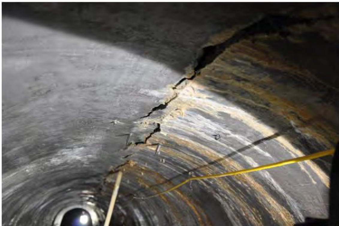
Abbildung 2.9: Zugrisse in der Firste des Stollens (Poisel, 2010).
