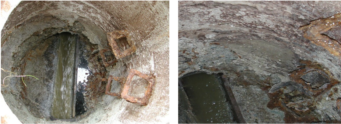
Abbildung 1: BSK im Anschluss an einen Hochpunkt mit Entlüftung; Pumpleitung 2 mal DN 400 mm, Länge ca. 7.600 m; nach ca. drei Betriebsjahren
