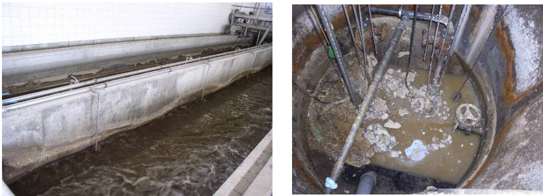
Abbildung 16: Beispiele für biogene Säure Korrosion (BSK) in einem Sandfang und in einem Zulaufschacht
