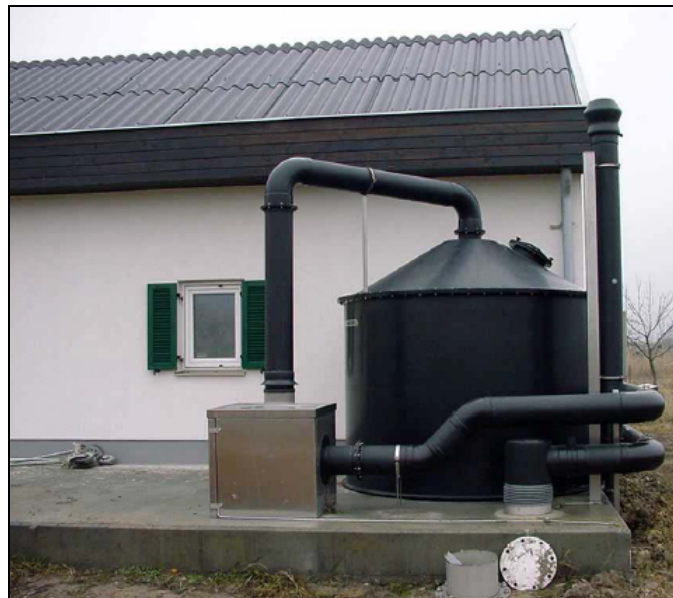
Abbildung 3: Biofilter PW Donnerskirchen Ortsgebiet
