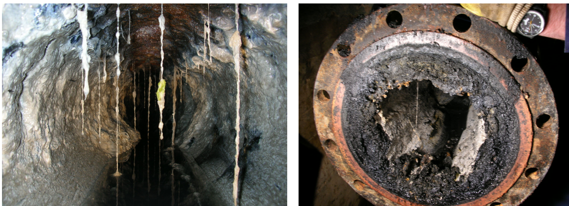
Abbildung 3: Ablagerungen und Sielhautschicht in einer Pumpleitung; DN 300 mm, Länge ca. 8.500 m; nach ca. 16 Betriebsjahren
