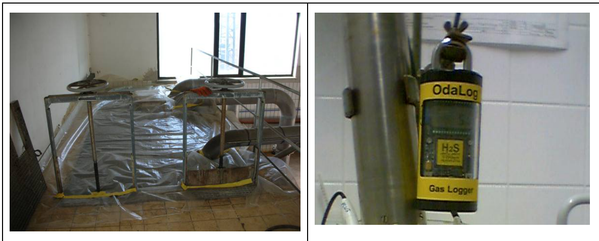
Abb 16: Abgedeckter Übernahmeschacht (links) und amperometrisches Sulfidgas-Messgerät (rechts)
