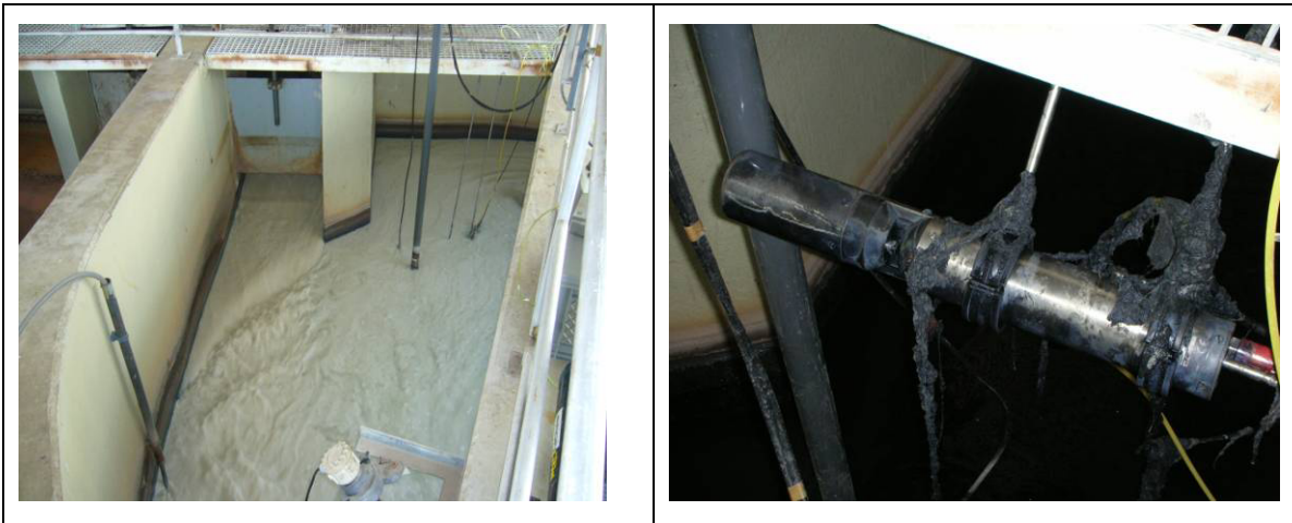
Abb15: Messstelle Rundsandfang (links) und in-situ UV-Spektrometer (rechts)
