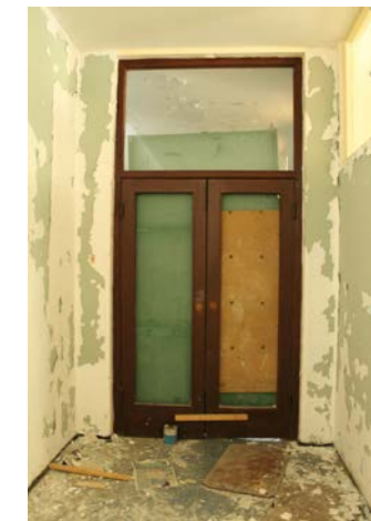
Abb. 106 Zugemagelte Tür zum Wartezimmer
