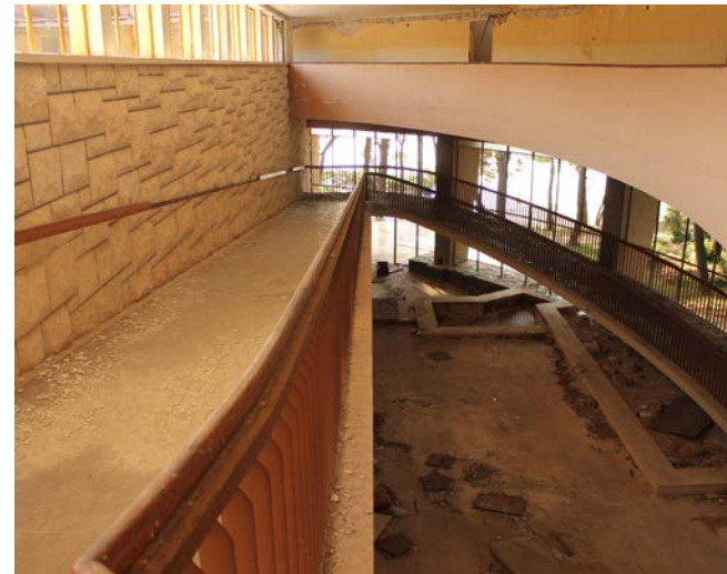
Abb.143 Setzungsrisse in der Betonbrüstung rechts
