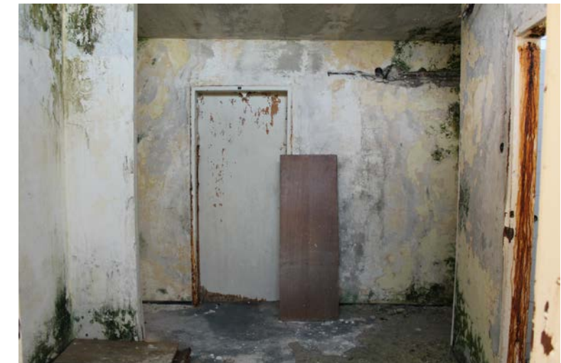
Abb.147 Wasserschaden in den Schlafeinheiten
