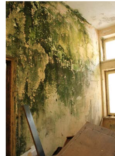
Abb. 144 Starker Wasserschaden in einigen Zimmern im EG
