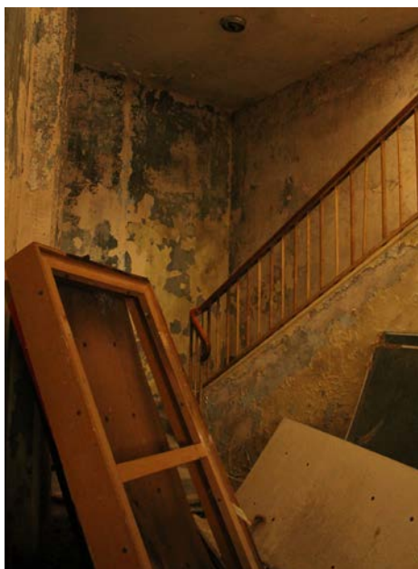
Abb. 83 Das Treppenhaus mit Wasserschäden
