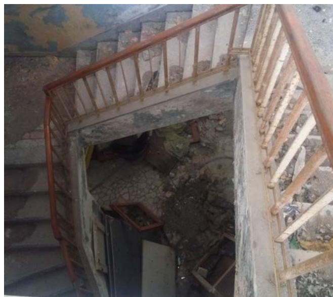
Abb. 86 Treppenhaus mit beschädigten Stufen aber erhaltendem Geländer
