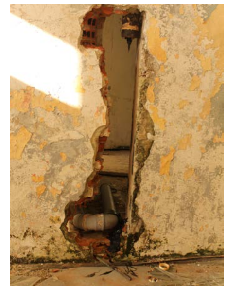
Abb.136 Loch in der Wand im Treppenhaus im Obergeschoss, es wurden Metallrohre entnommen
