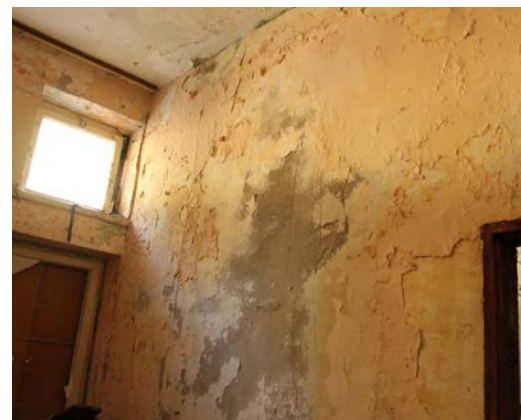
Abb.96 Aufgeweichte Wände in Zimmer 9, die Putzschichten sind abgeblättert, der Türrahmen verrostet
