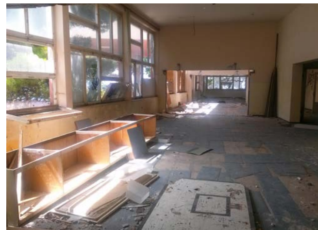
Abb.62 Gemeinschaftsräume mit kaputten Fenstern und fehlenden Türstöcken
