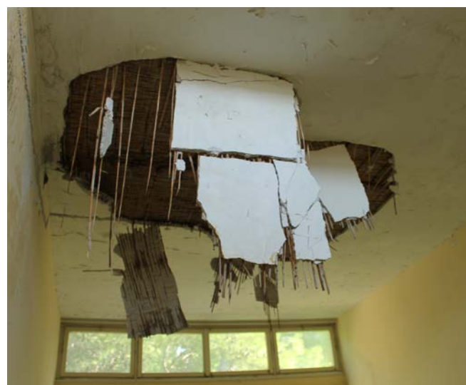
Abb.149 Loser Putzträger in den Schafzimmern im OG
