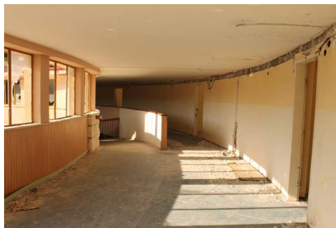
Abb. 117 Korridor im Obergeschoss. Gut sichtbar sind die Schäden entstanden durch rausgerissene Kabel
