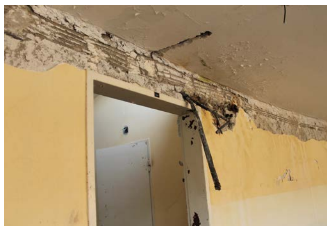
Abb. 119 Im Korridor sind alle Kabel rausgerissen
