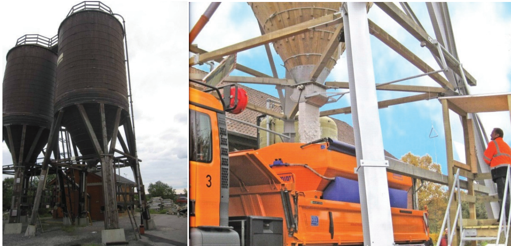
Abb. 10: Silo (Wr. Neustadt West) und Streufahrzeugbefüllung mittels Silo 16
