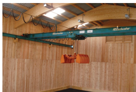
Abb. 25: Zweiträger-Brückenkran in Lagerhalle (Baden)
