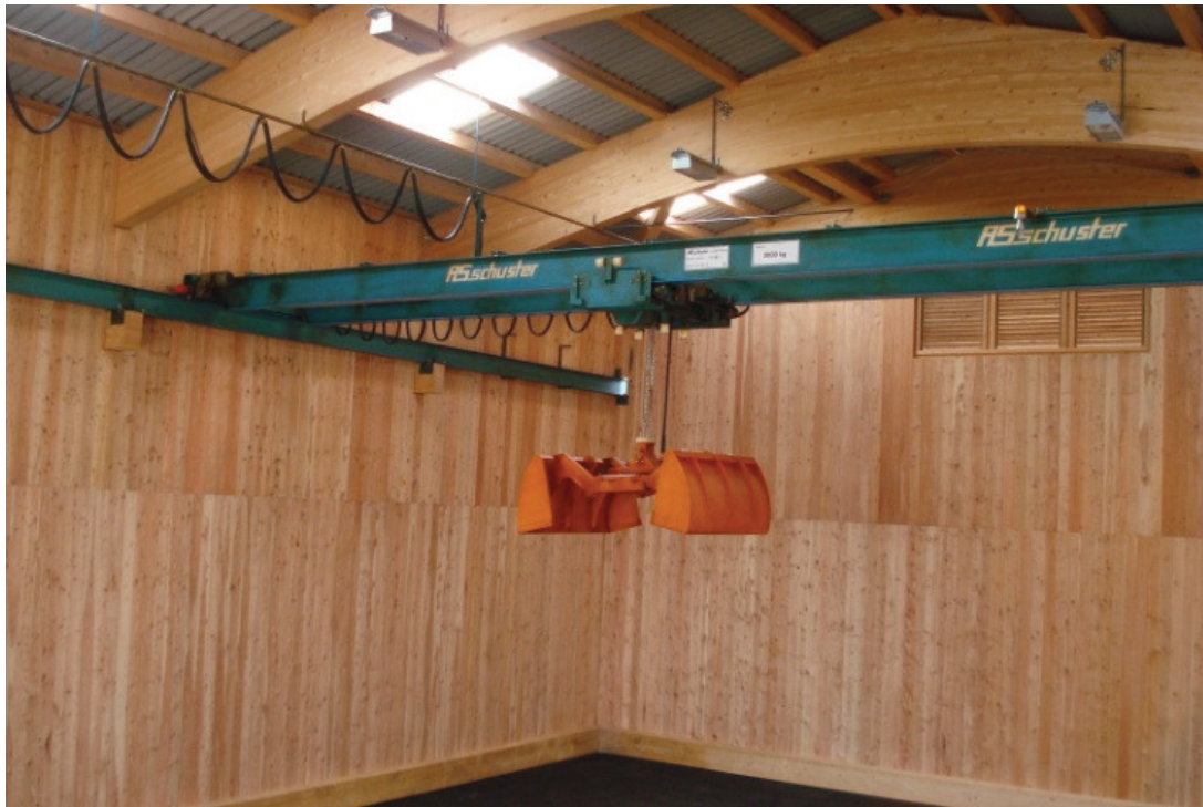
Abb. 25: Zweiträger-Brückenkran in Lagerhalle (Baden)
