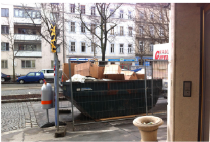
Eingezäunte Baumulde, 1020 Wien
