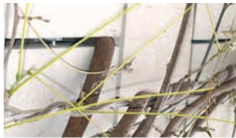
Abbildung 16 - Bauschaden durch Kletterpflanze
