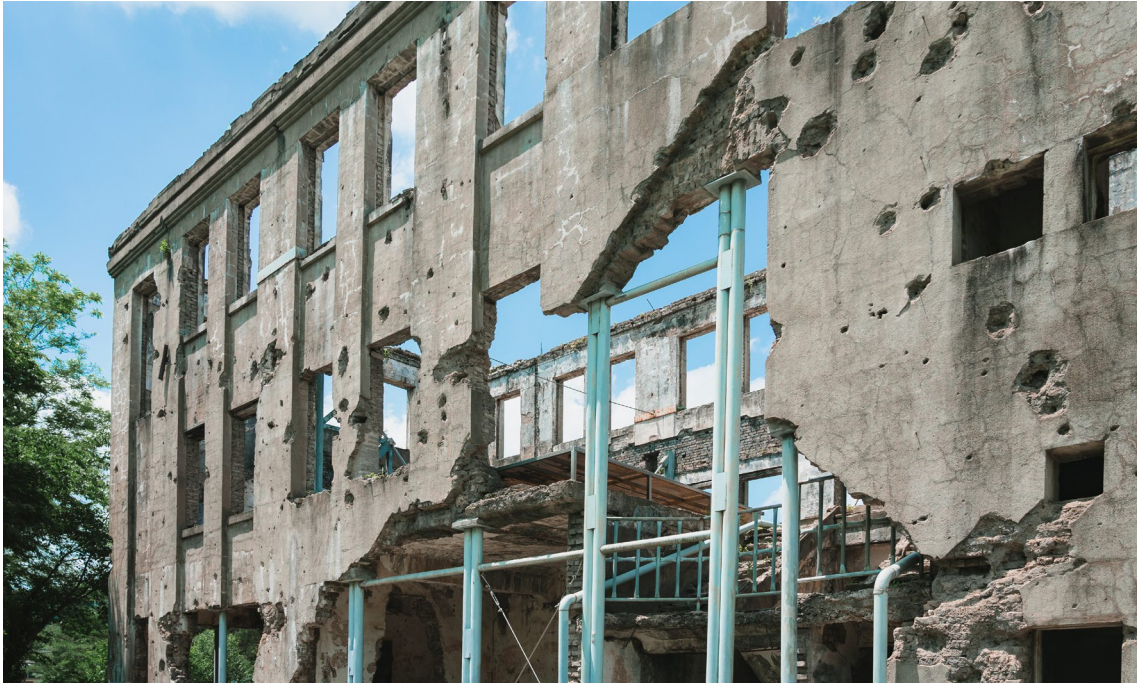
Abb.26: Der Zustand des Dachs und des Bodens und Einschusslöcher an den Außenwänden
