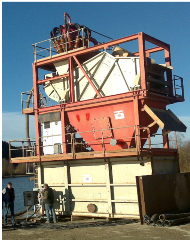
Abb. 31: Separieranlage AKA SEP 400 (Fa. AKW)
