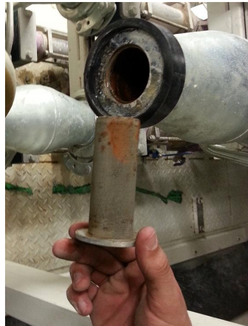
Abb. 3-9: Schaumlanze "Bubble Tube" mit Sieb als Störkörper - Green Line Underground Doha
