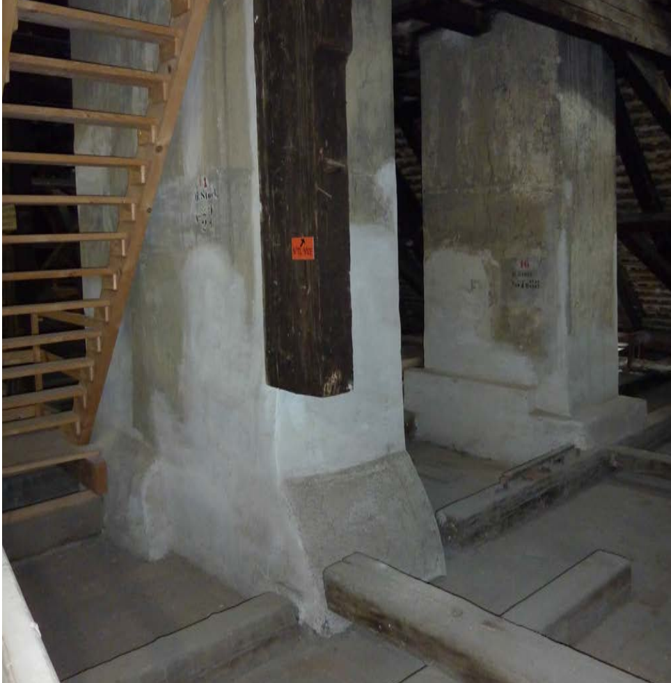
Abbildung 54 Blick auf abgeschnittene Hängesäule in Gespärre 3
