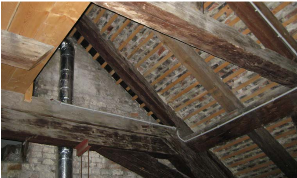
Abbildung 90 Blick auf fehlenden Kehlbalken im Gespärre 4.2
