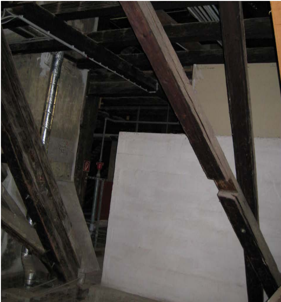
Abbildung 26 Blick auf Schäden des NW-Dachwerks auf Grund des Stiegenaufgangs der Säulenstiege
