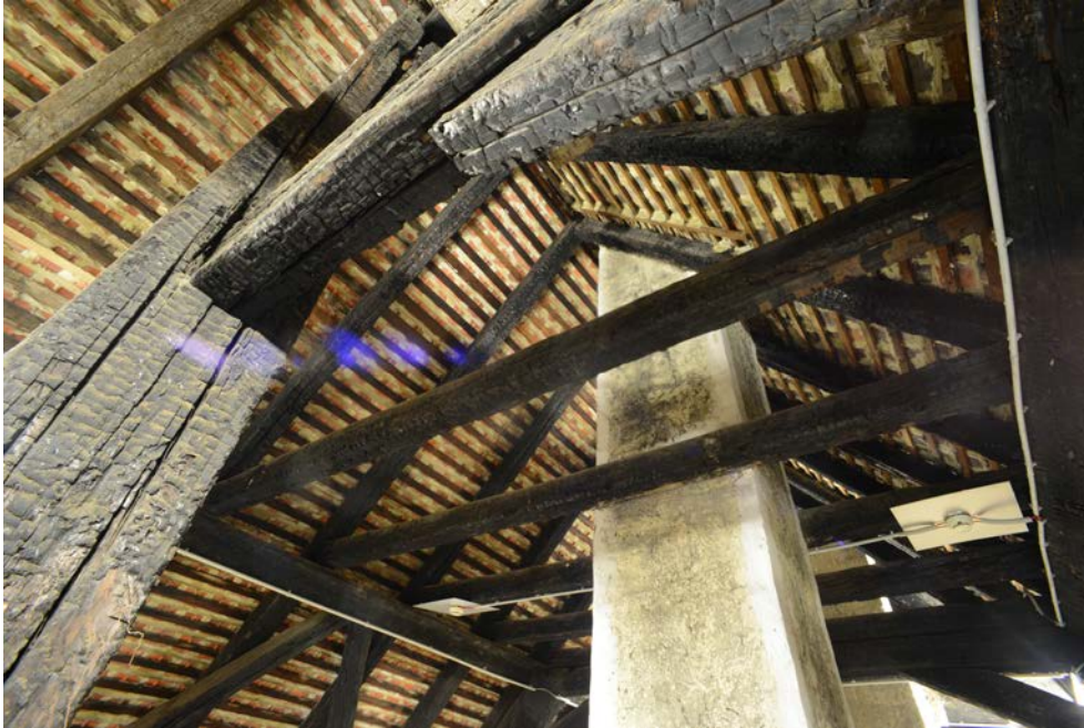
Abbildung 59 Blick auf Brandschaden im nordöstlichen Dachwerk
