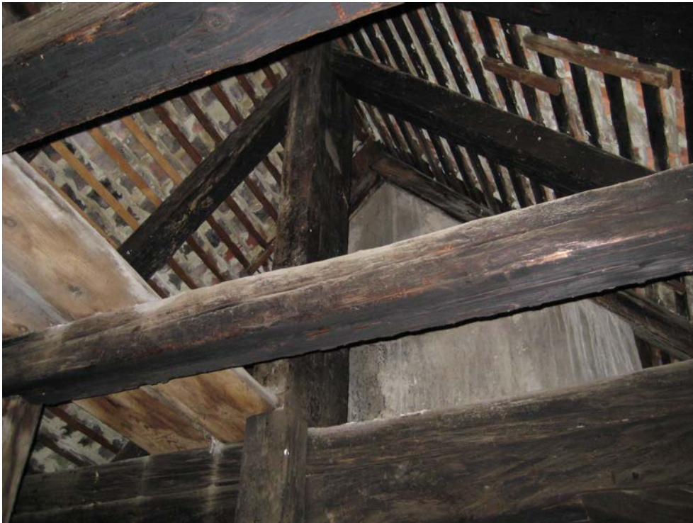
Abbildung 57 Blick auf Gespärre 6: beide Streben des einstelligen Hängewerks im 3.OG wurden entfernt
