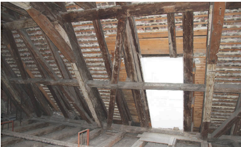
Abbildung 116 Blick auf fehlende Druckstrebe zwischen Gespärre 9 und 9.2
