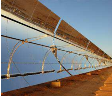
Anhang 1: Parabolic Through Kollektor im Kollektorfeld 275
