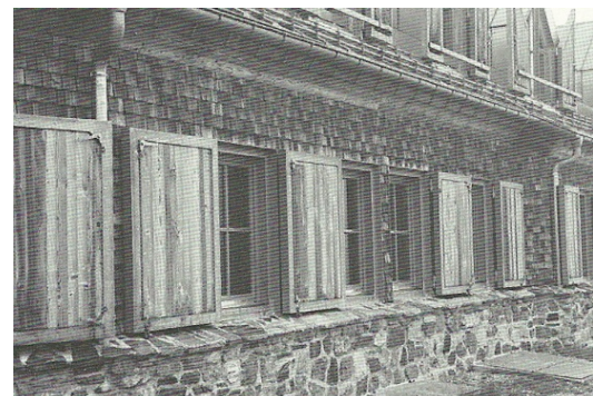
Abbildung 97: Verstärkte Fensterläden aus Holz gegen Lawinendrücke (©Siegfried Sauermoser) 204
