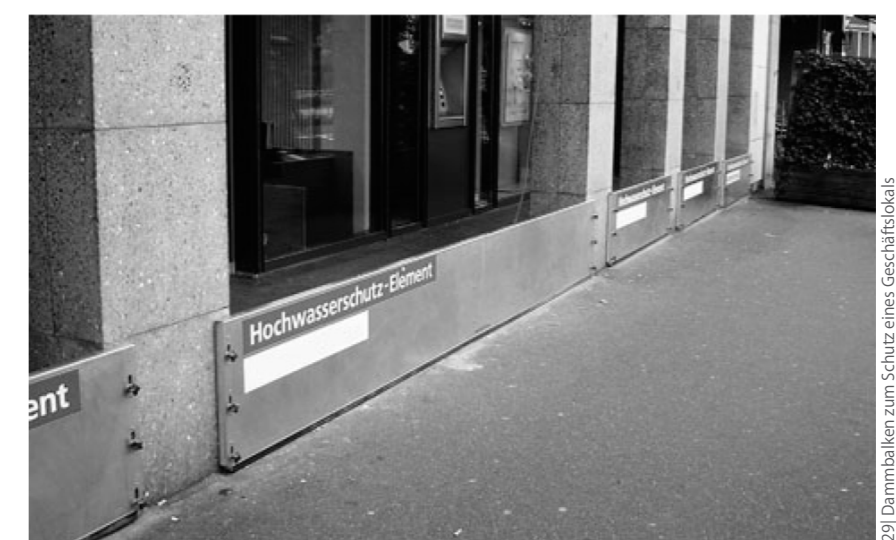
29| Dammbalken zum Schutz eines Geschäftslokals
