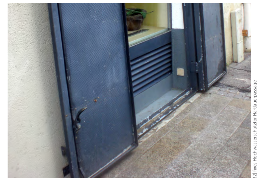
32 | fixes Hochwasserschutztor Hartlauerpassage
