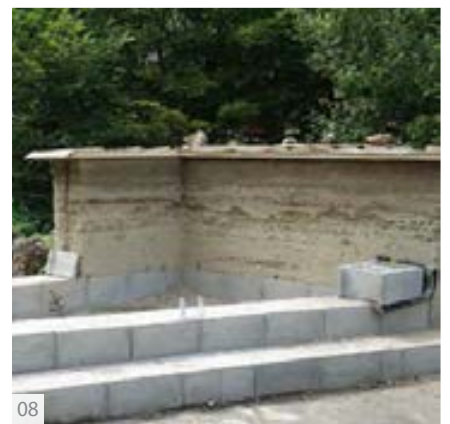
Abb. 01.6: Stampflehmwand nach Bauphase I Abb. 01.7: Abplatzungen und Durchfeuchtung nach den Wintermonaten Abb. 01.8: Stampflehmwand nach Bauphase II
