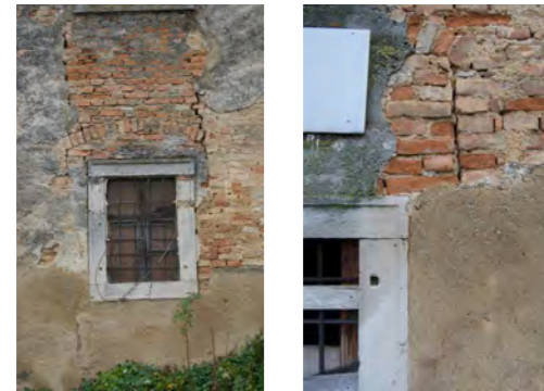
Abb. 36 und 37 l: Westfassade, Öffnung F02 r: Öffnung F04, durchlaufende Fuge, kein Verband
