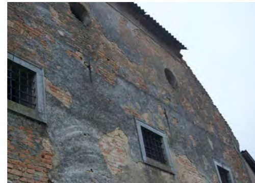
Abb. 38 Westfassade, Öffnungen F27-F29 im OG und F39-F40 im DG, großflächige Putzschäden und sichtbare Tramschließen
