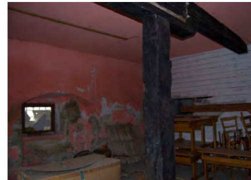
Abb. 99 Raumnr. R10, Öffnung F14, Holzstütze mit Ausklinkungen, Holz-balkendecke mit nachträglich verschlossener Untersicht
