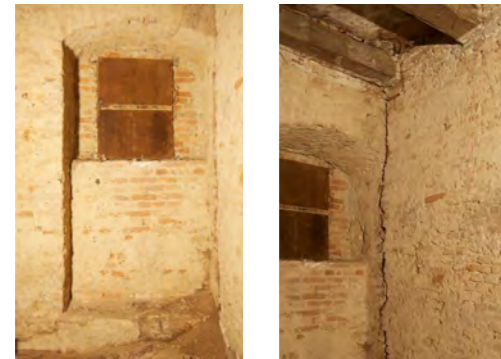
Abb. 59 und 60 Öffnung F01, großer durchlaufender Riss im Mauerwerk, kein Verband der Innen- und Außenwand
