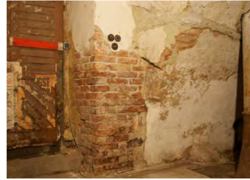
Abb. 71 Putz- und Salzschäden, Ziegelmauerwerk (Außenwand und Gewölbeansatz), Elektroinstallationen
