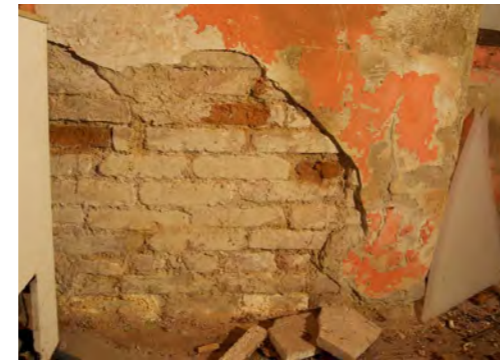
Abb. 102 Putz- und Salzschaden, Ziegelmauerwerk im Läuferverband
