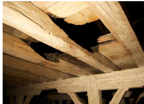
Abb. 121 Brandschaden in der Holztrammede
