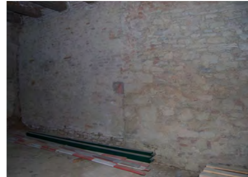
Abb. 58 Vertikalfuge im Mauerwerk
