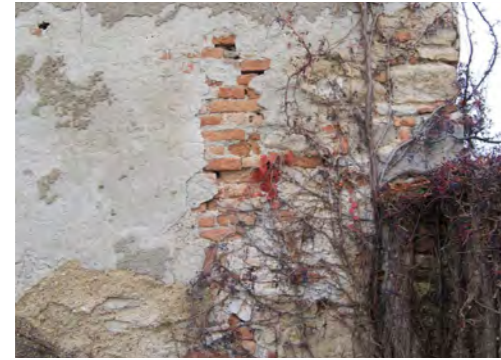
Abb. 29 Südfassade, Putzschäden zwischen EG und 1.OG
