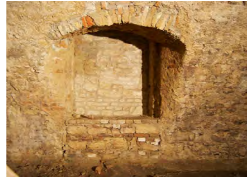
Abb. 45 Kellernische N03, abgemauert gegen Erdreich
