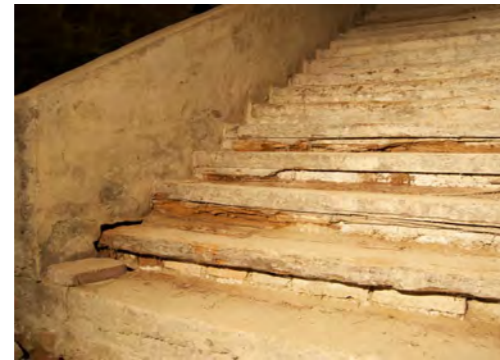
Abb. 41 Kellerstiege, Detailansicht der morschen Treppenkonstruktion
