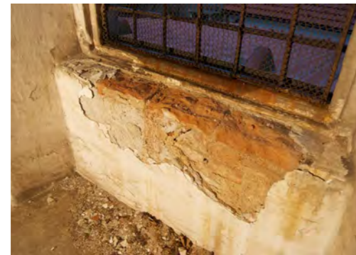
Abb. 124 Öffnung F34 mit Putzschaden am Parapet
