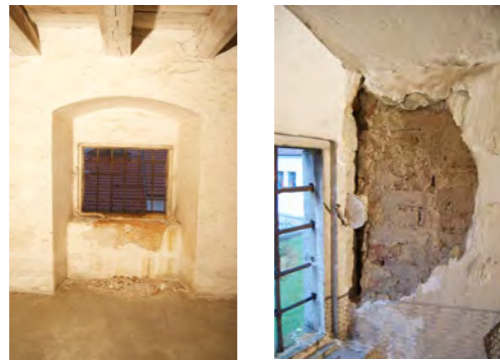
Abb. 125 und 126 l: Öffnung F34 r: Putzschaden an Außenwand bei Öffnung F29
