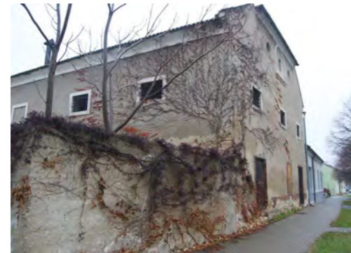
Abb. 26 Ost- und Südfassade, Misch- und Ziegelmauerwerk verputzt, teils große Putzschäden
