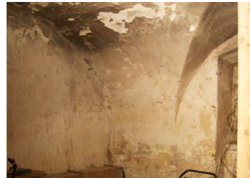
Abb. 85 Gewölbeansatz mit Brandspuren
