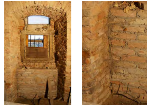
Abb. 66 und 67 l: Öffnung F04 r: Parapet vermutlich nachträglich aufgemauert
