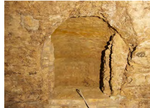
Abb. 44 Kellernische N02, offen zum Erdreich, deutlich sichtbare Sedimentschichten
