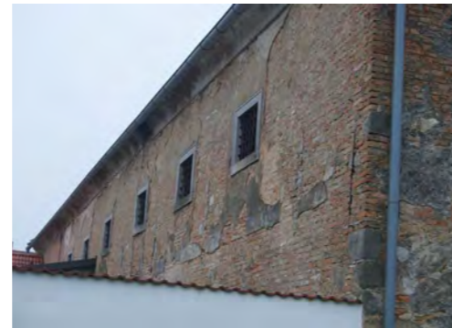
Abb. 39 Nordfassade, Öffnungen F30-F35, großflächige Putzschäden und sichtbare Tramschließen
