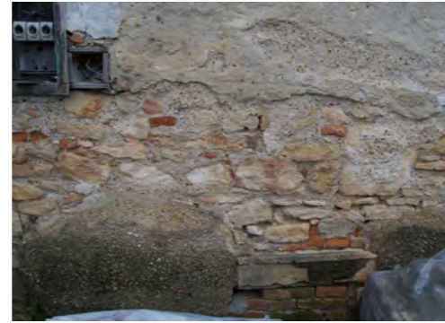
Abb. 31 Südfassade, Putzschäden und Elektroinbauten EG
