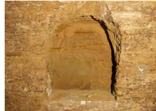
Abb. 43 Kellernische N01, offen zum Erdreich, deutlich sichtbare Sedimentschichten
