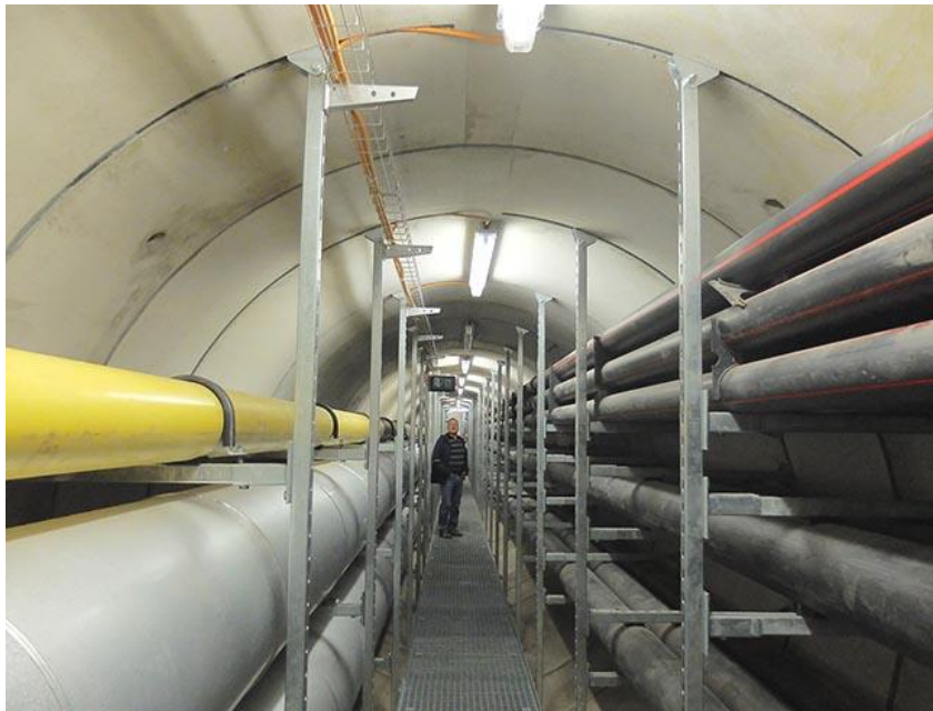
Abbildung 41: Infrastrukturkanal mit einem Durchmesser von 3,4 m und 21 darin enthaltenen Rohrleitungen mit unterschiedlichem Nutzen [9].
