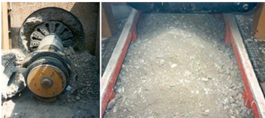
Abbildung 46: Abbau und Zerkleinerung des Altrohres aus Beton (links). Zerkleinertes Rohr aus unbewehrtem Beton (rechts) [81].
