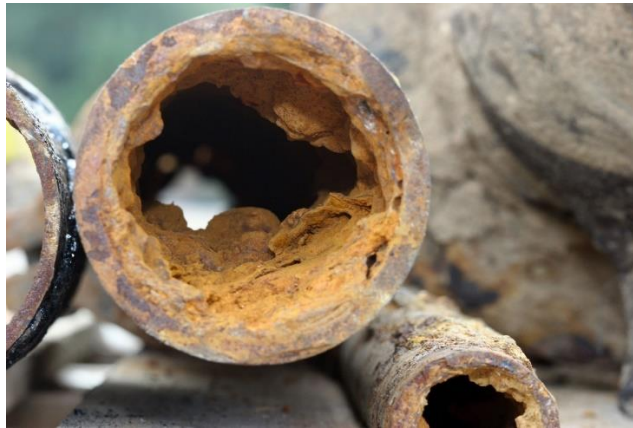
Abbildung 29: Altes Wasserrohr mit sichtbaren Ablagerungen [89].
