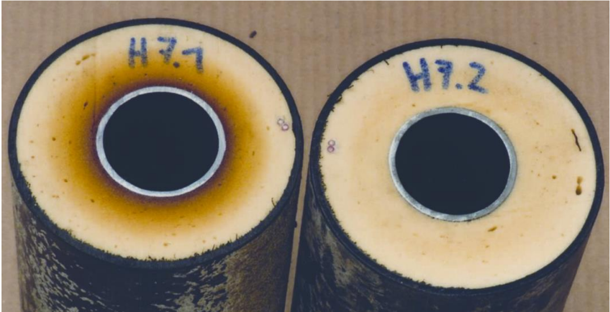
Abbildung 27: Fernwärmerohre aus PUR-Schaumstoff nach einer Nutzungsdauer von in etwa 16 Jahren. Das linke Rohrsystem wurde mit einer höheren Temperatur beansprucht und zeigt Verfärbungen auf [61, S.2].
