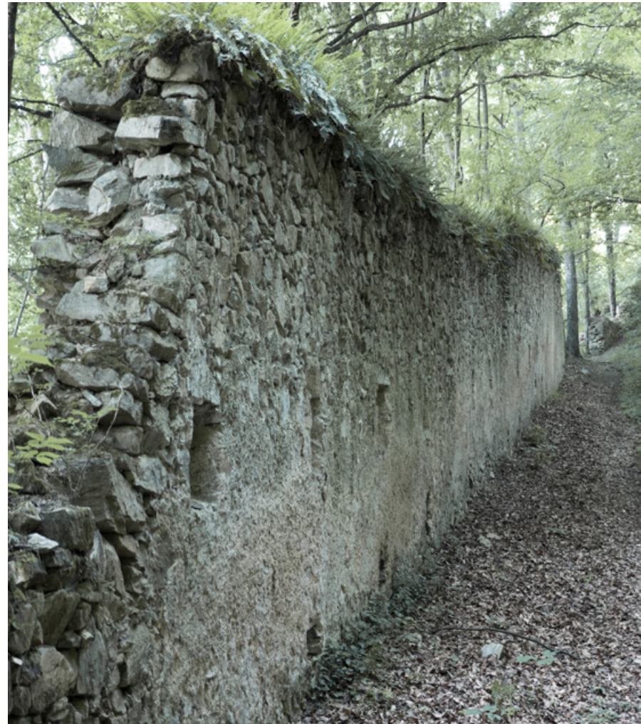
Abb 41 Grüne Mauerkrone | Ruine Landsee
