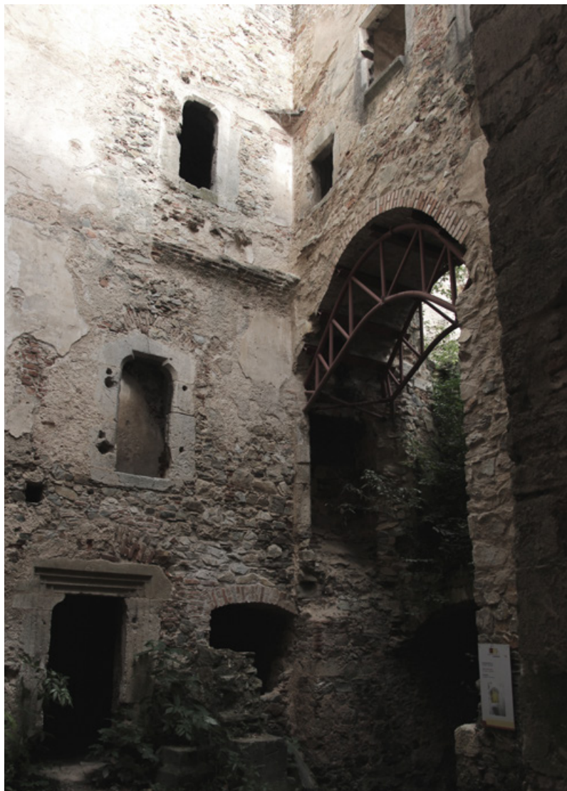
27 Hinter der großen Öffnung befand sich früher die Kapelle, links davon zweistöckhohe Wohnungen. (im Zuge einer großen Sanierung in den 90er Jahren wurden bereits Sicherheitsvorkehrungen eingebaut um die Tragfähigkeit zu gewährleisten)
