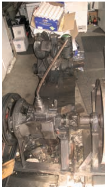
Abb. 123: Antrieb durch Dieselaggregat
