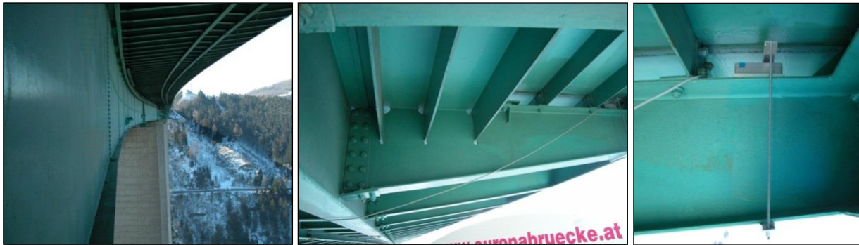
Bild 14: Kragarmuntersicht mit Beschleunigungs-Aufnehmer im Bereich des Gehsteigs (rechts & Mitte) bzw. Brückenuntersicht-Standort WL Nord (links)
