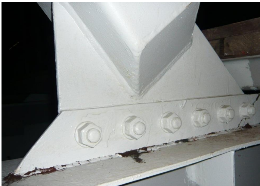
Bild 108: Entlang des Knotenblechs durchgerissene Schweißnaht am unteren Anschluss einer Diagonalstrebe
