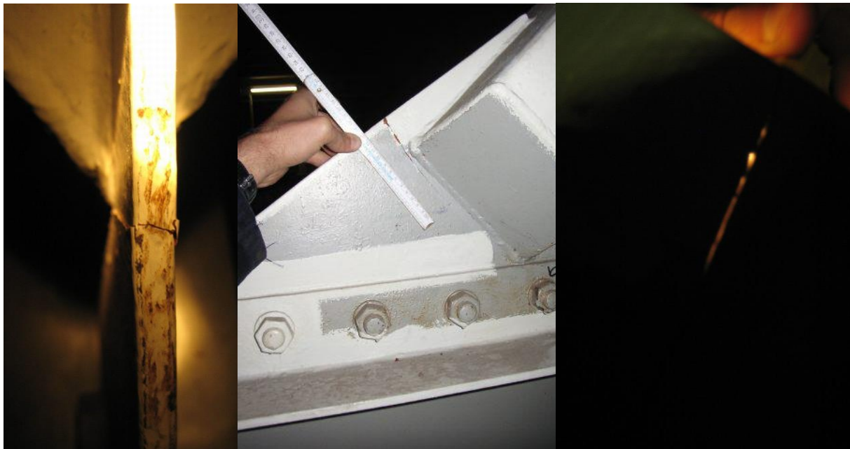
Bild 105: Rund 13 cm langer Ermüdungsriss im Anschlussblech zwischen 4-Kant-Diagonale und Bodenplatten-Querträgerflansch - Strebe V 24 QV-N
