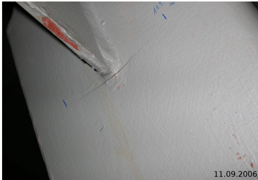
Bild 107: Charakteristisches Rissbild am oberen Anschluss der Diagonalstrebe (zwischen den blauen Markierungen)
