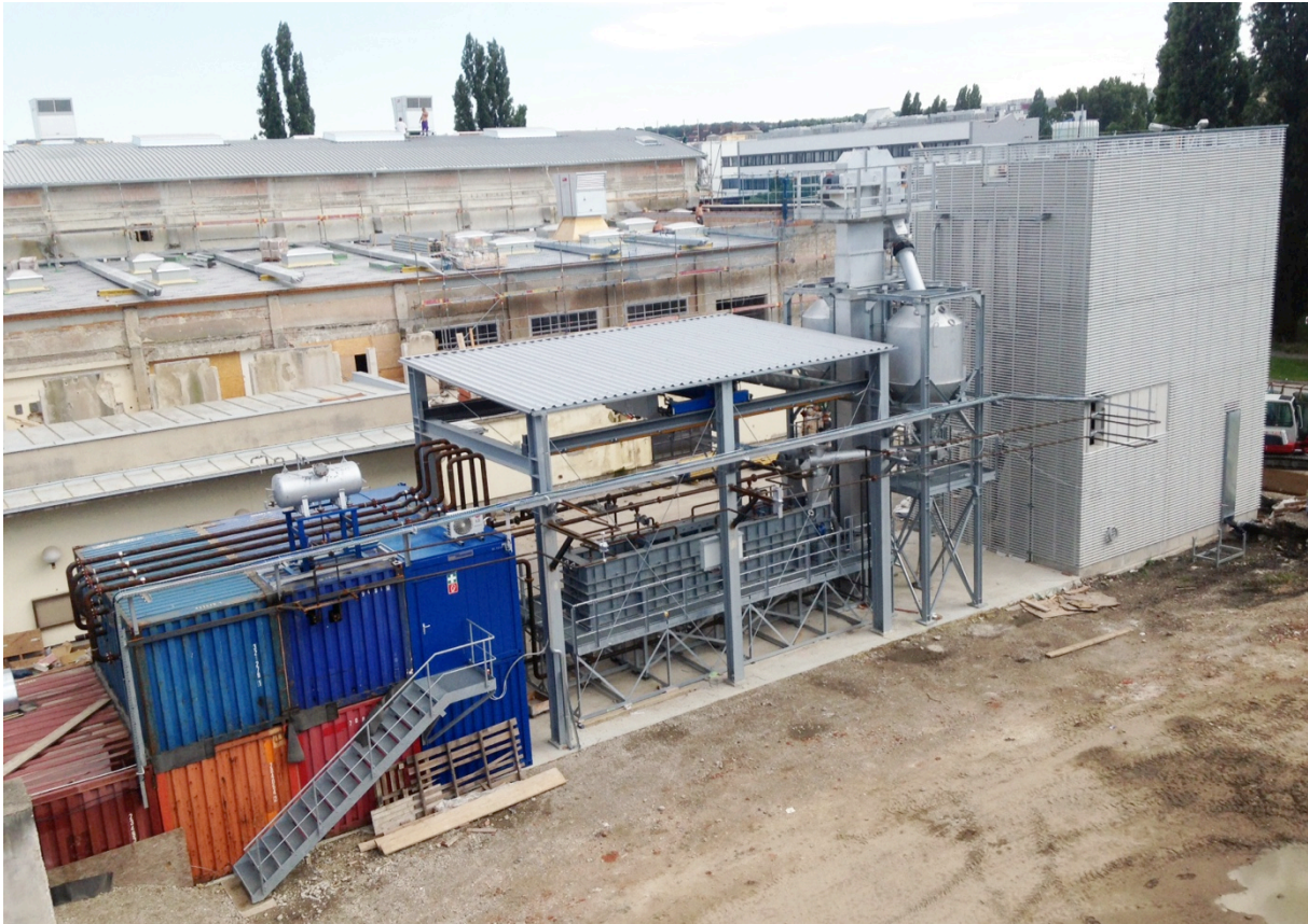
Abbildung 8: Versuchsanlage Standort Arsenal
