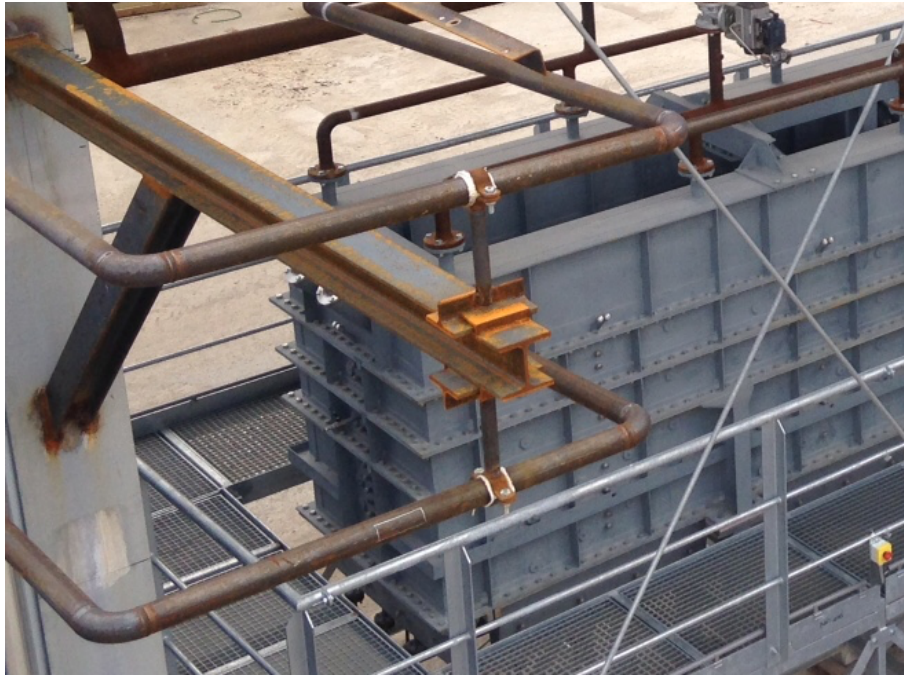
Abbildung 38: Rohraufhängung mittels Gleitschuh
