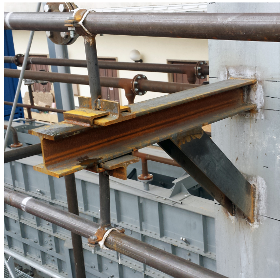
Abbildung 3.3: Rohrkonsole mit Gleitschuh
