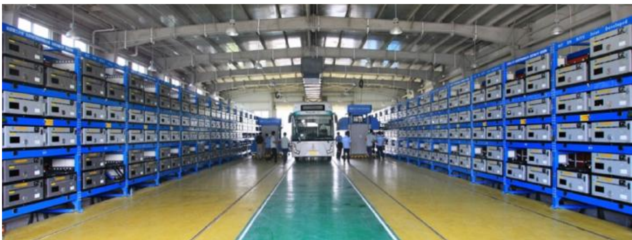
Abbildung 21 – Batteriewechselstation von DB Tech [29]
