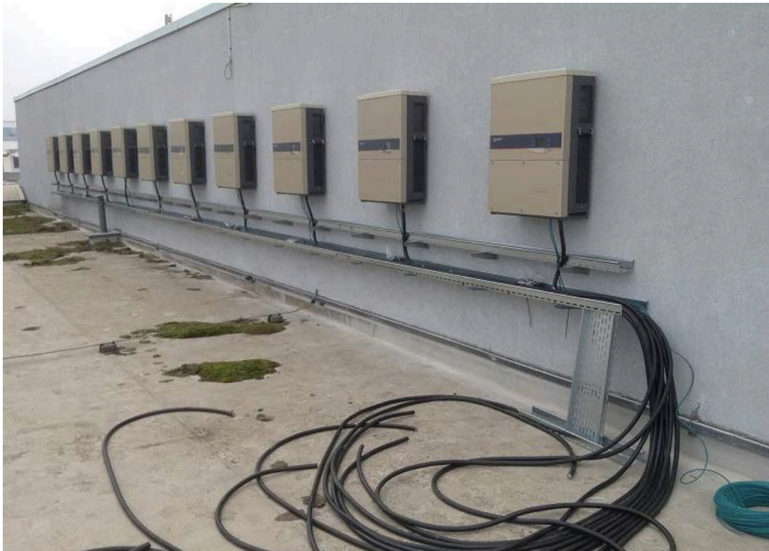
Abb. 11: Wechselrichter Photovoltaikanlage Wien 22, Quelle: Sunmade
