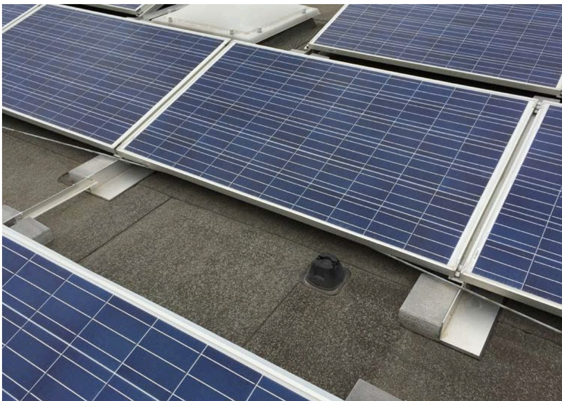
Abb. 12: Photovoltaikmodule auf Flachdach Anlage Wien 22, Quelle: Sunmade
