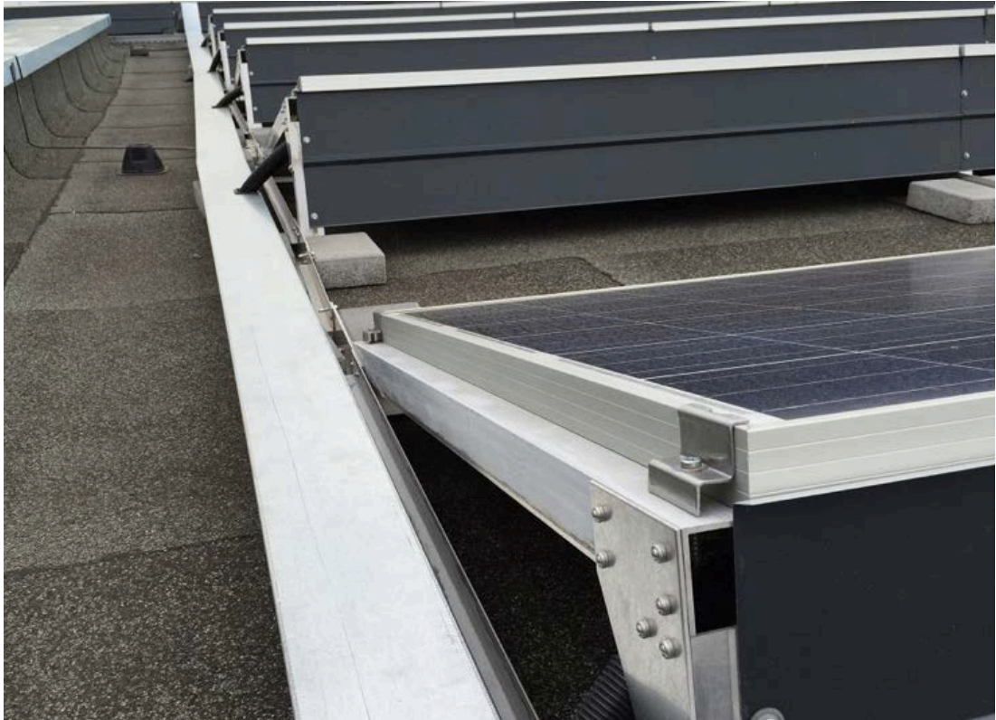
Abb. 13: Module und Modulaufständerung Photovoltaikanlage Wien 22, Quelle: Sunmade
