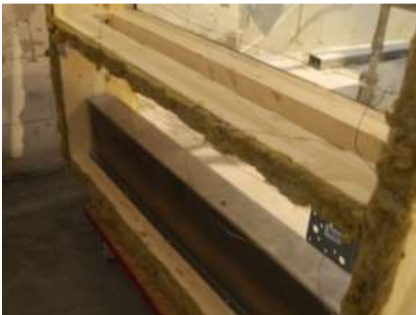
Abb. 5.90: V2 - Zuluftöffnung und Jalousiekasten (Ansicht von der Rückseite) [Foto des Autors]
