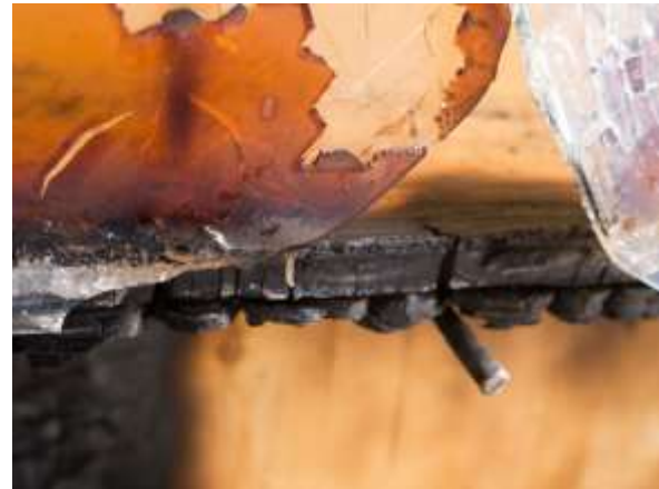
Abb. 5.173: Detailansicht Glasbruch beim Auflager [Foto des Autors]
