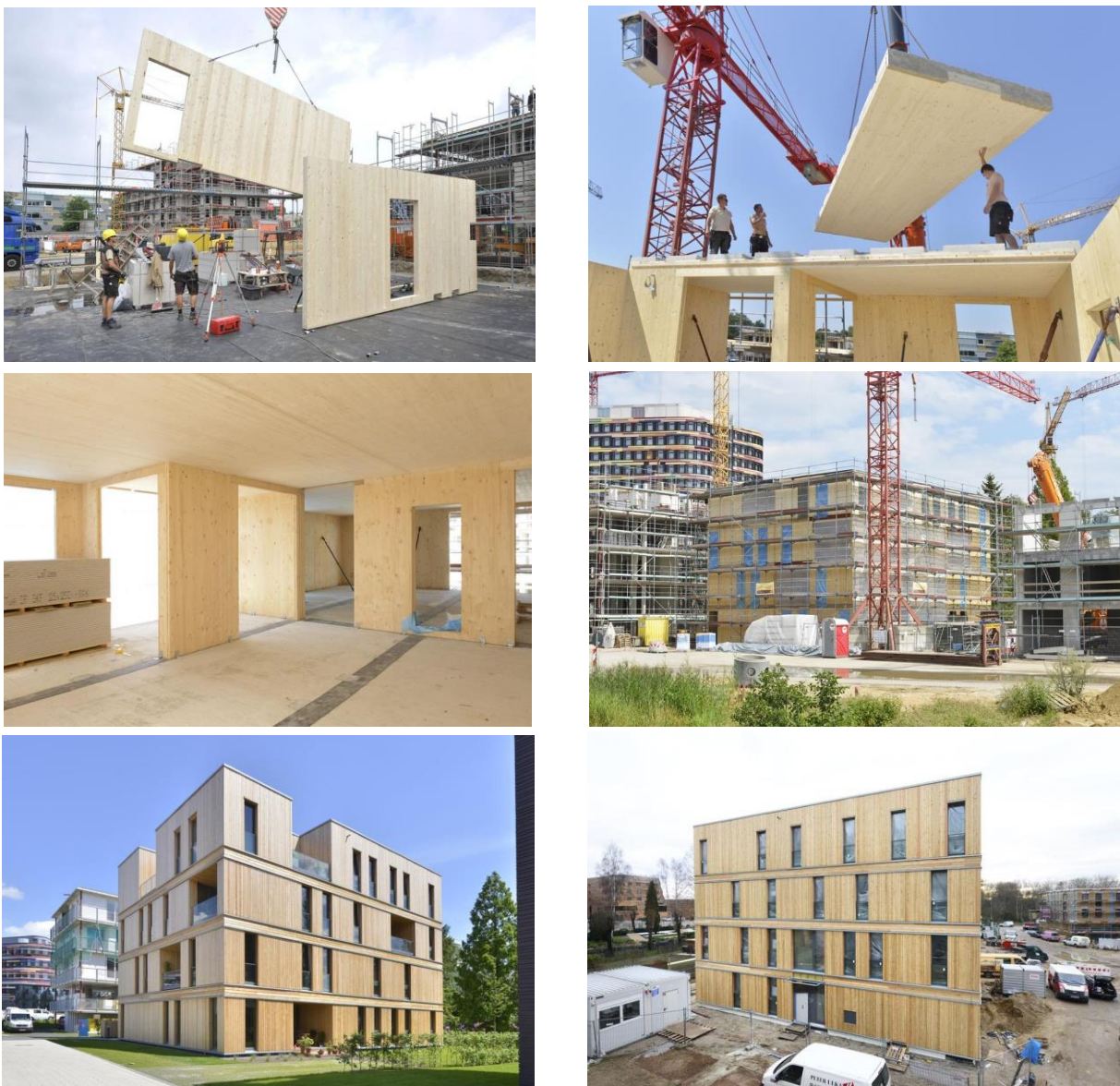
Abbildung 5-13: Bauprozess der Case Study Hamburg: Tragstruktur aus Holz, Decken in Holz-Beton Verbund [80]
