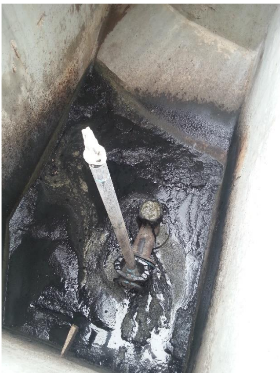
Abbildung 50: Mit der Flux-Chamber-Methode untersuchter Schlamm-schacht von Faulturm 1
