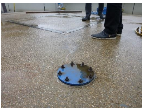
Abbildung 33: Riss im Behälter
