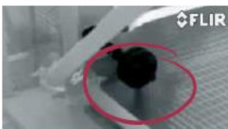
Das Gasleck ist auf dem Wärmebild klar zu erkennen.
