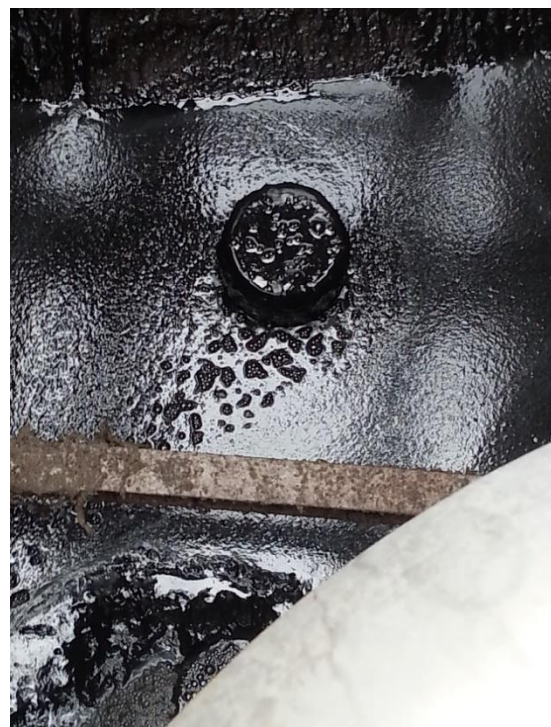
Abbildung 51: Steigrohr von Faulturm 2 mit Gasblasen im verdrängten Schlamm
