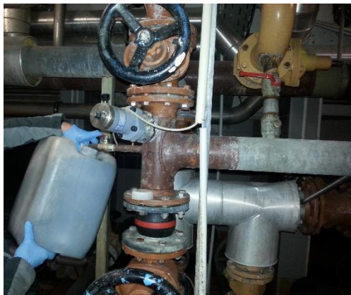
Abbildung 61: Probenahmestelle aus der Umwälzleitung vor der FS-Umwälzpumpe
