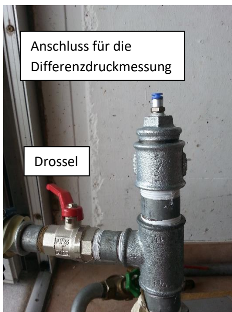
Abbildung 36: Druckstutzen mit Drossel und Anschluss für die Differenzdruckmessung
