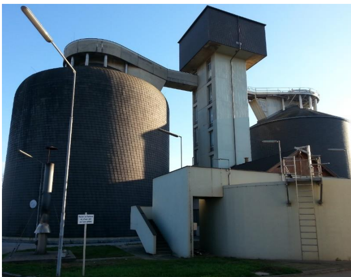
Abbildung 41: Untersuchte Faulungsanlage, 2 Behälter (2 x 5.250 m 3 ) links vorne Fackel, rechts einer der beiden statischen Voreindicker
