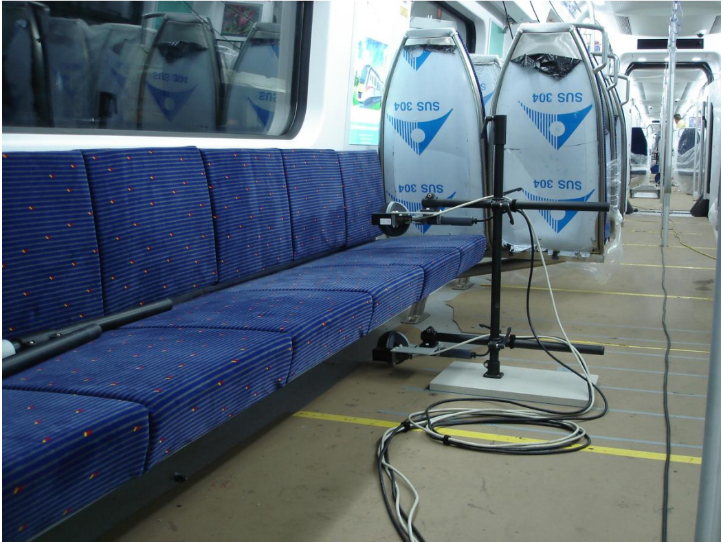
Abbildung 11-12: EMU, AC-Fahrzeug, Anordnung zur Messung nach Kundenforderung und zur Verifikation der Transformatorspezifikation(2)
