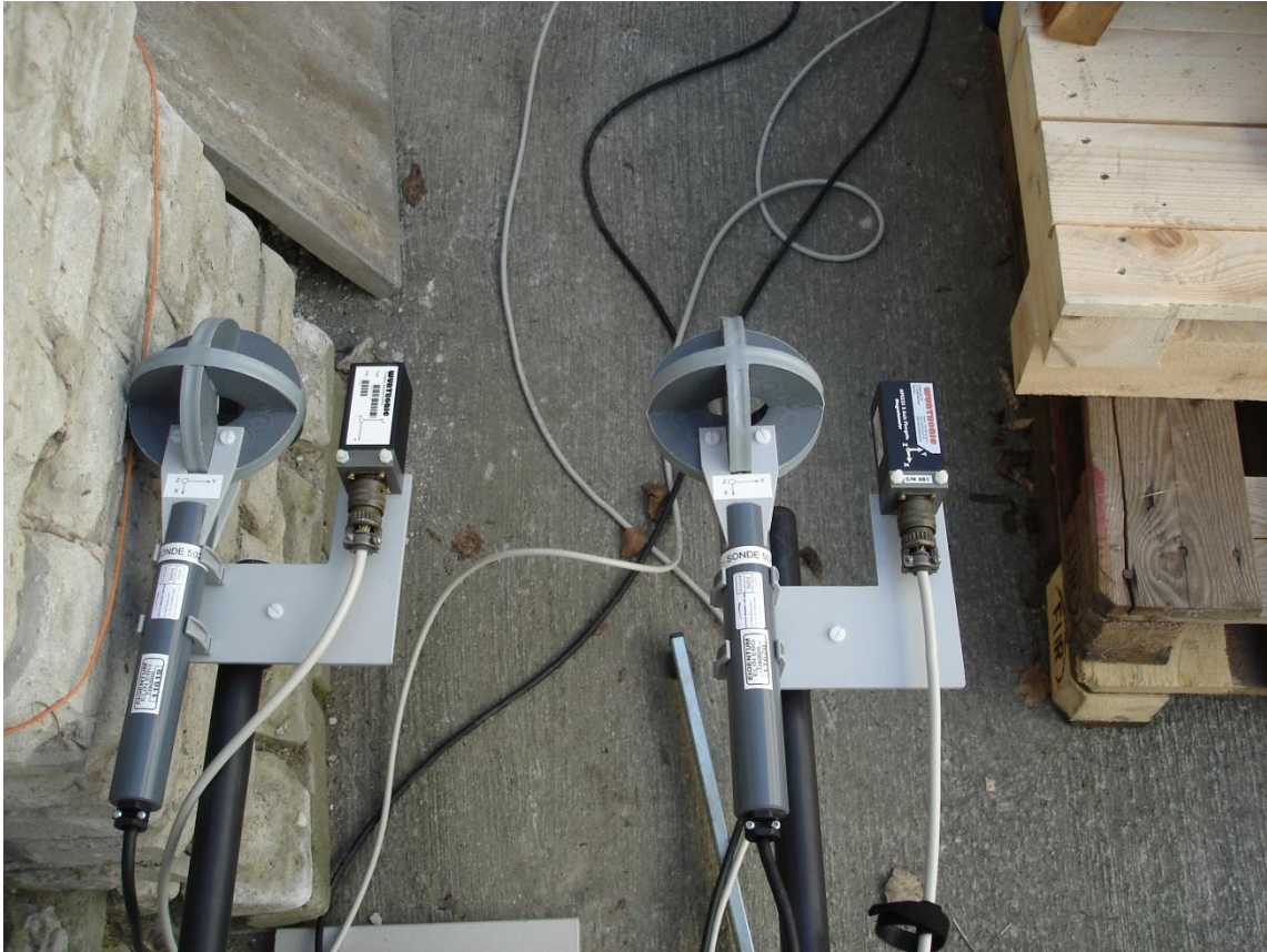
Abbildung 10-3: Magnetfeldmessung Traktionsmotor DC an möglichen Positionen der ATP-Antenne
