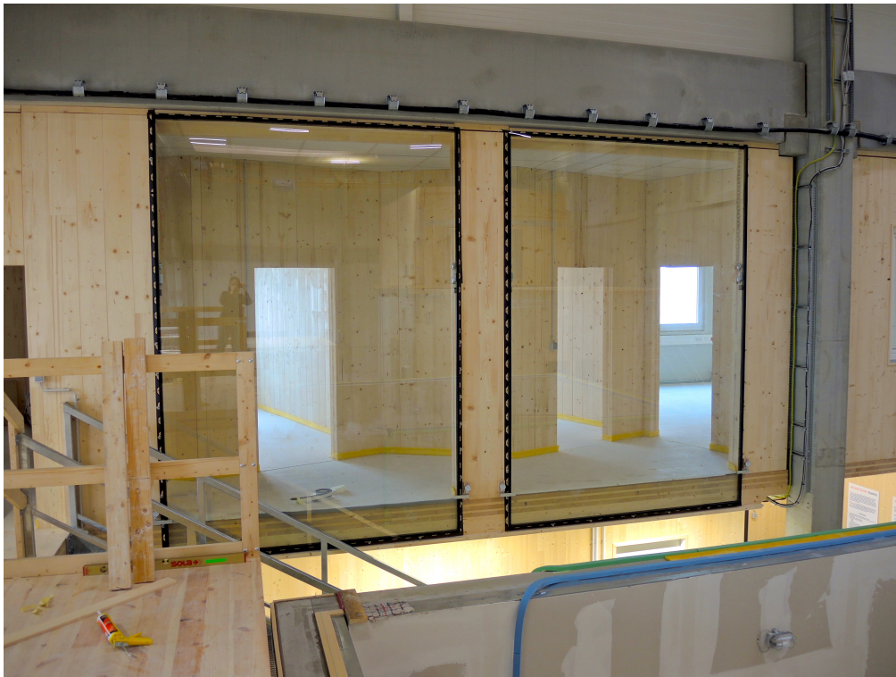
Abb. 3.1: Fertig montierte HGV-Elemente im Versuchsstand (Ansicht von der Werkshalle aus) – links HGV-Element SÜD und rechts HGV-Element NORD
