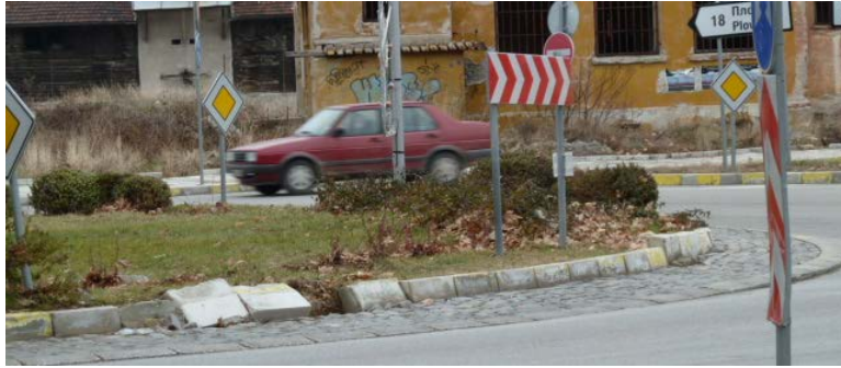
Abb.93 Randbeschädigung im Kreisverkehr, Assenovgrad, Bulgarien [89]
