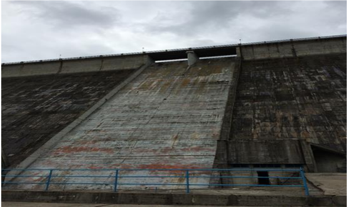
Abbildung 5.2 - Tosbecken Chaira Damm Bulgarien
