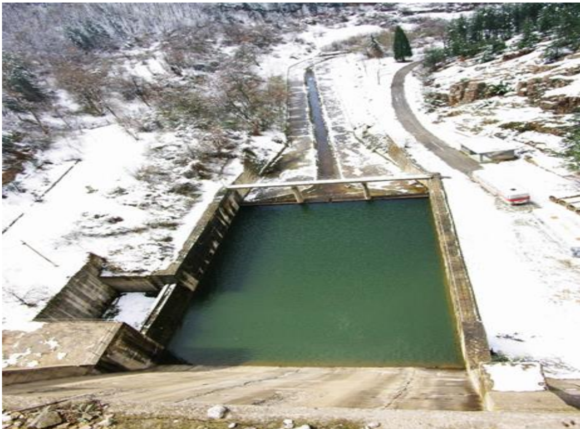
Abbildung 5.1 - Erosion an einem Störkörper (Tosbecken Studena Damm-Bulgarien)
