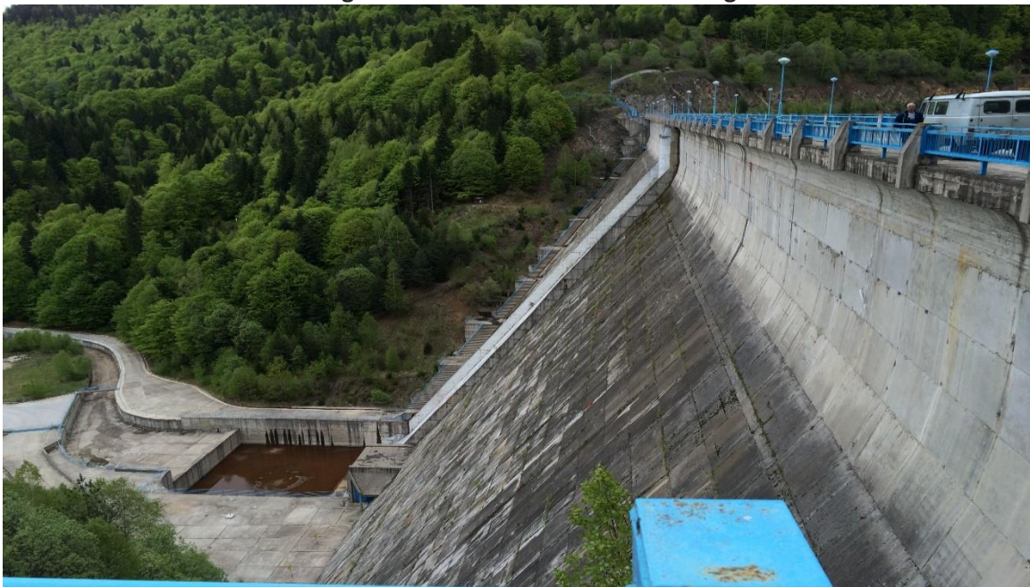
Abbildung 5.3- Tosbecken Chaira Damm Bulgarien
