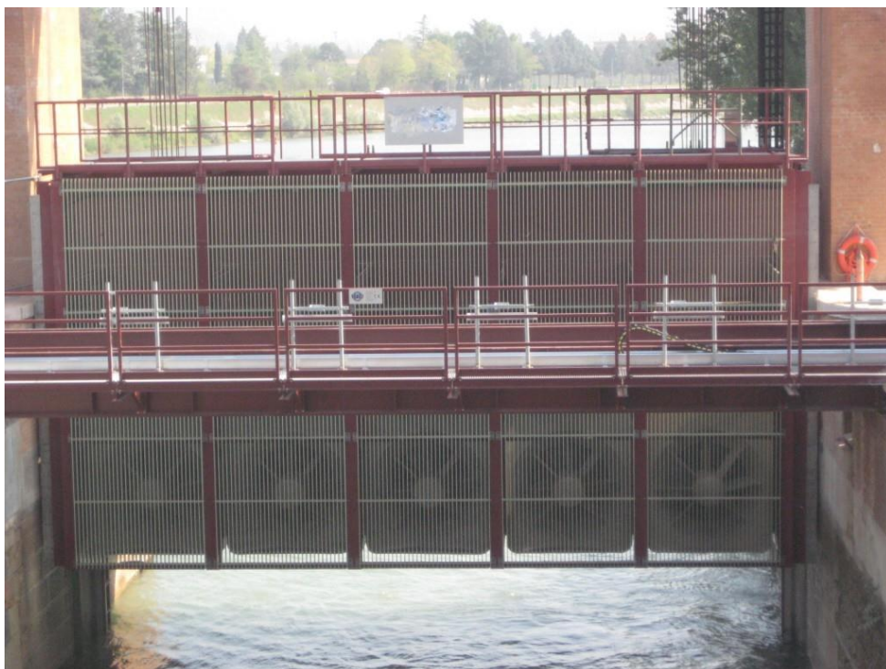
Abb. 4.9 Hydromatrix beim Entnahmebauwerk, Chievo, Italy [6]
