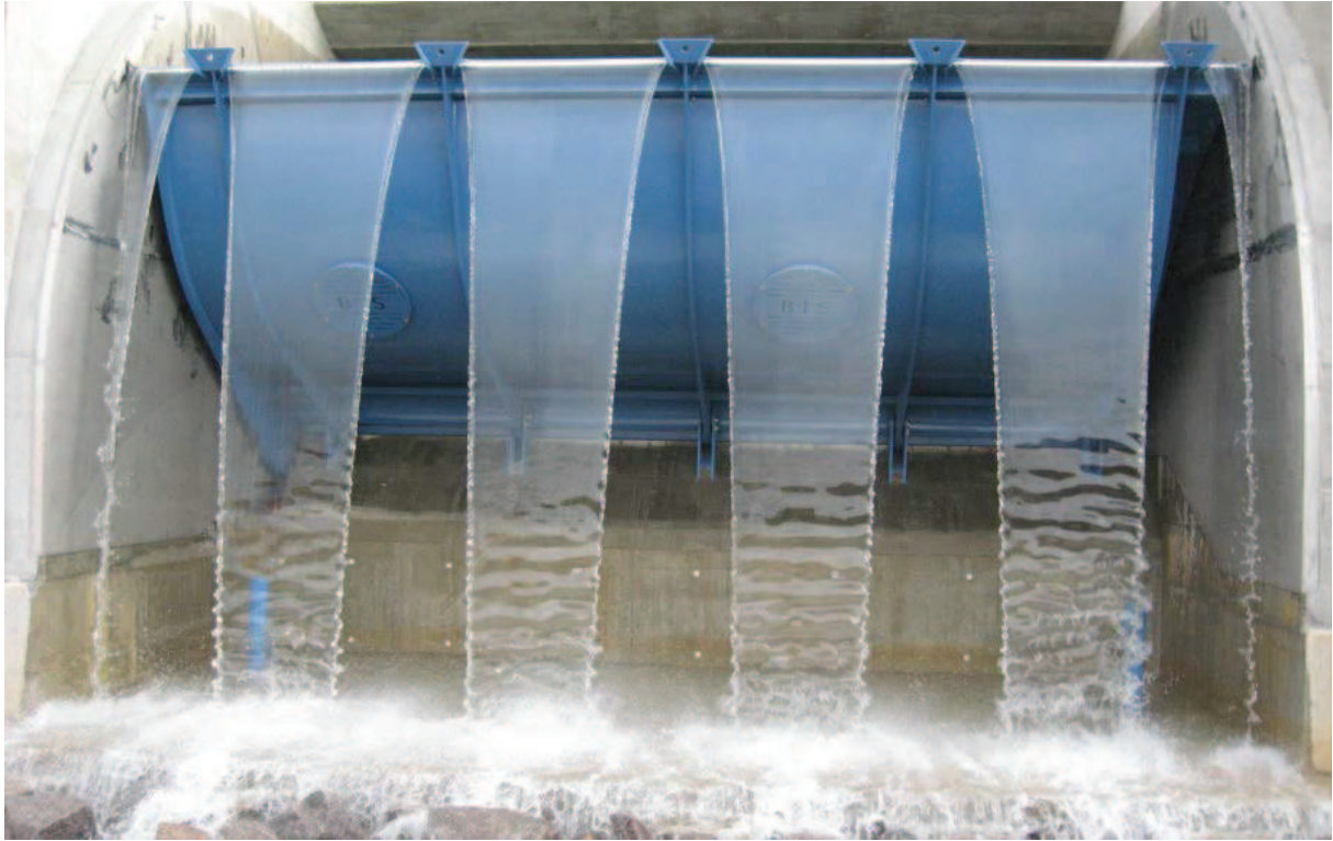
Abb. 5.17 Strahlaufreißer einer Fischbauchklappe [unger-ingenieure.de]
