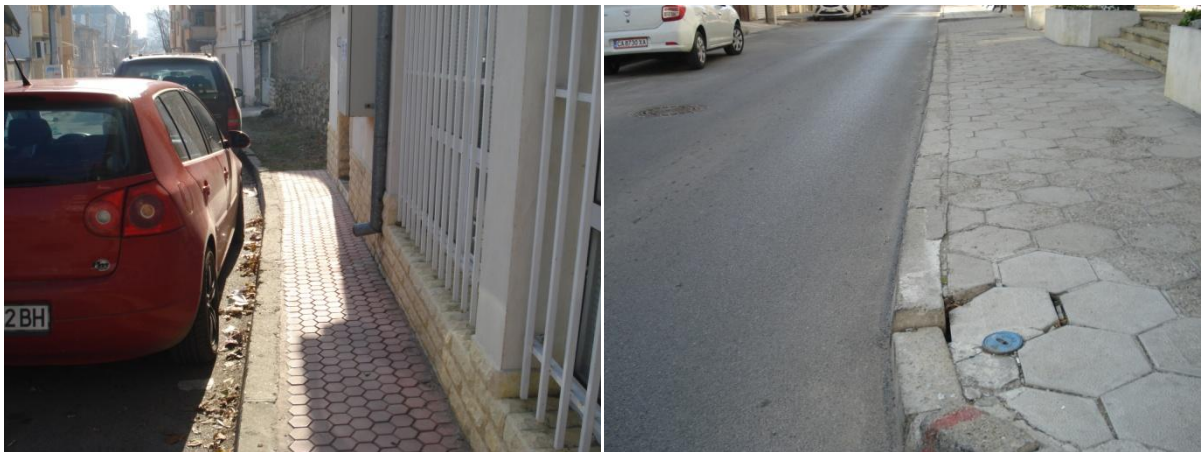
Abbildung 65: „Slivnitsa“ Straße und „Gen. Stolipin“ – sehr schmale Gehwege, fehlende Bordsteinabsenkung
