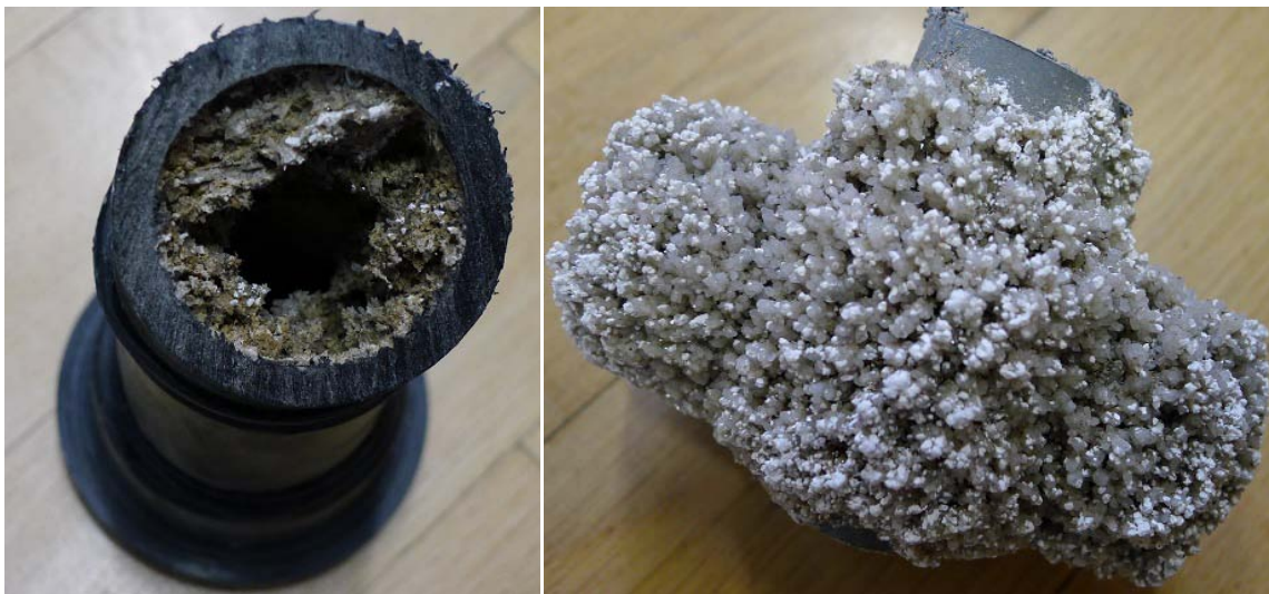
Abbildung 3-1 MAP-Inkrustationen an Rohrleitungselementen
